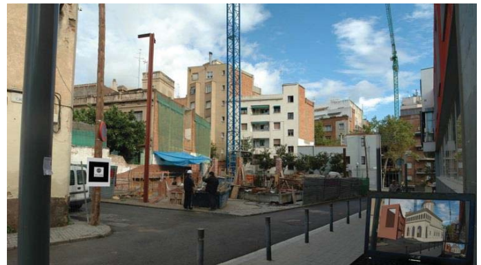
Figura 5. Fotografía con webcam de la obra con el marcador AR-media sobre el poste izquierdo y la visualización del modelo virtual en RA en el monitor.
