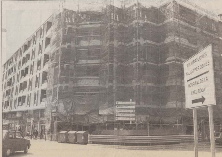
Obras de reparación en la fachada de un edificio en la plaza de Blas Infante.
