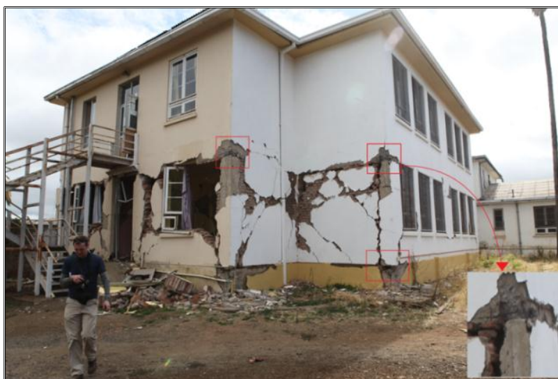
Figura 3.9 Hospital con daños severos en terremoto de Chile en 2010 ( http://gallery.usgs.gov/ )
