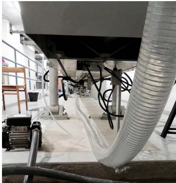
Figura A61. Canonada semi-transparent que transporta la mescla d'aigua i de llim dels tancs (al fons de la imatge) al canal.
