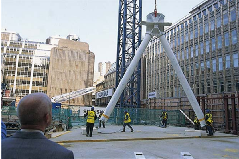
Figura 6.4. Unidad de marco estructural en “A” que conforma la estructura de acero tubular de la rejilla diagonal. Hay 18 unidades en el contorno perimetral de cada planta. Arranca en el piso a nivel de suelo y llega al piso 38. En esa altura hay 19 unidades, una por cada dos plantas.
