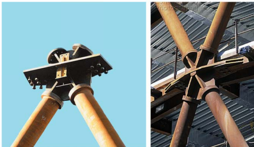
Figura 6.5. Detalle del nudo estructural del interior del marco metálico de acero tubular de los encuentros de detalle del nudo estructural encuentro de los marcos metálicos de la rejilla diagonal. En la parte inferior del nudo confluyen dos diagonales del marco estructural en “A” y en la parte superior descansan los arranques inferiores de los marcos desplazados de las bases de dos marcos distintos.
