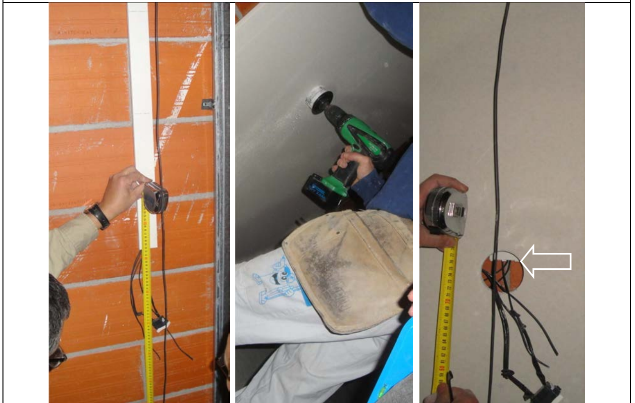
Fotografia 16: Error en la posició de la perforació per prendre la referència des de la part inferior de la placa. La canaleta sobresurt massa i pot impedir la instal·lació del mecanisme.
