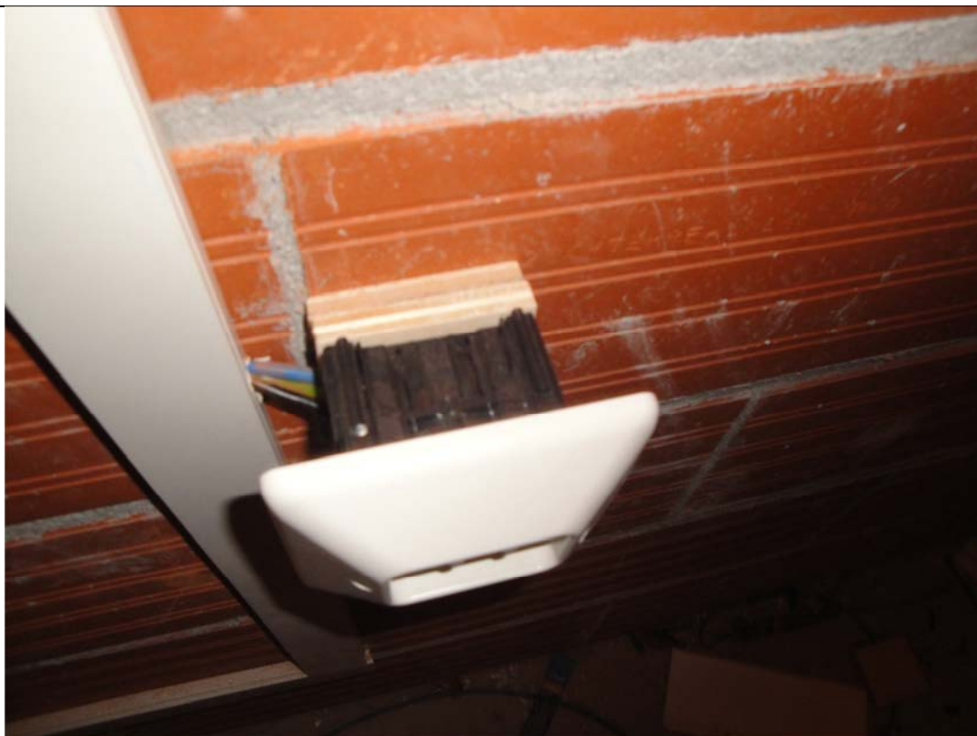
Fotografia 25: Presa de corrent de la cuina.
