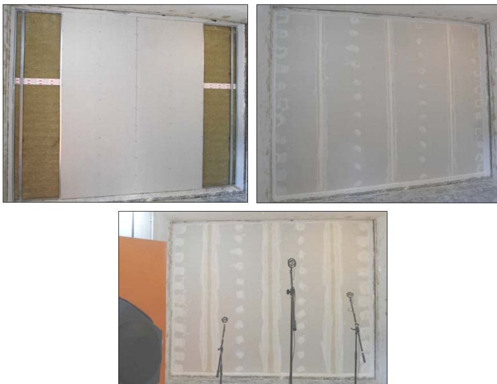
Imágenes 10 a 12 Colocación de la PYL y cerramiento listo para el ensayo
