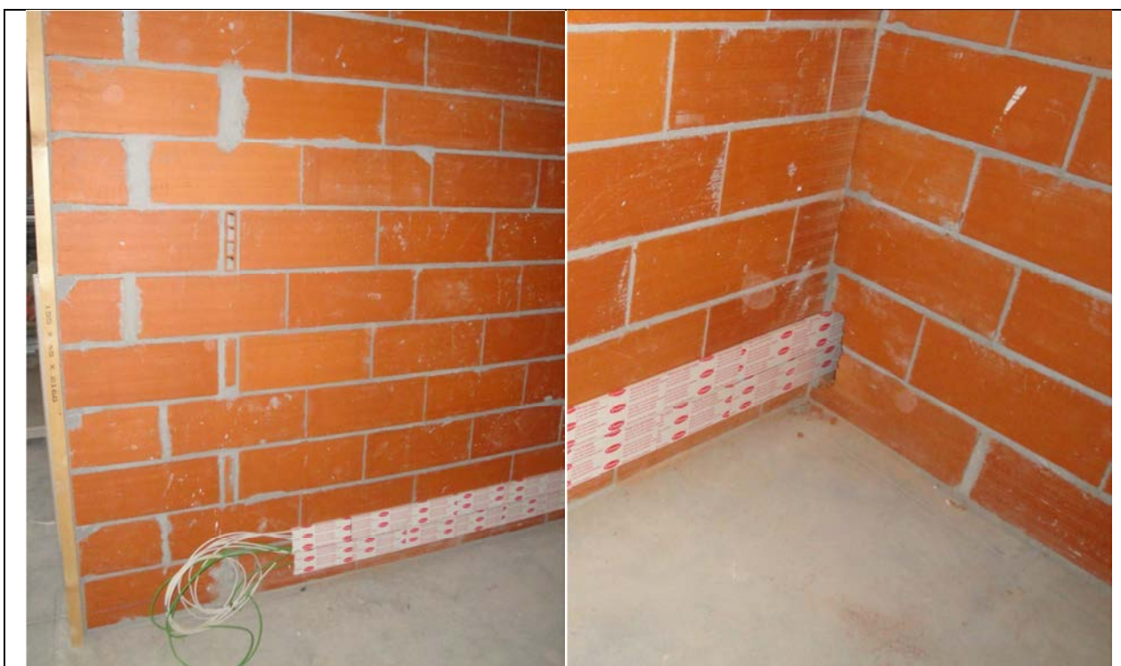
Fotografia 7: Cablejat de telecomunicacions a la sala d'estar.
