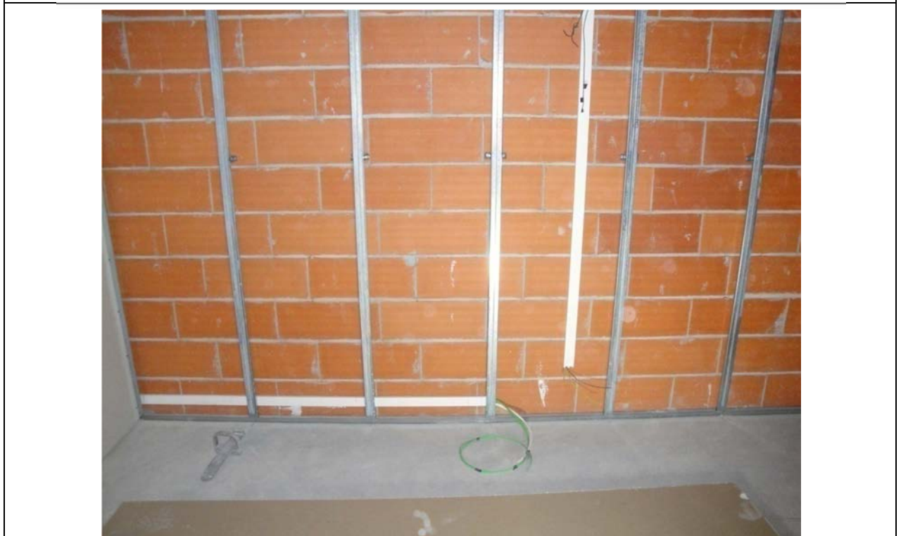
Fotografia 6: Part de la instal·lació del dormitori. Vertical: electricitat. Horitzontal: telecomunicacions.
