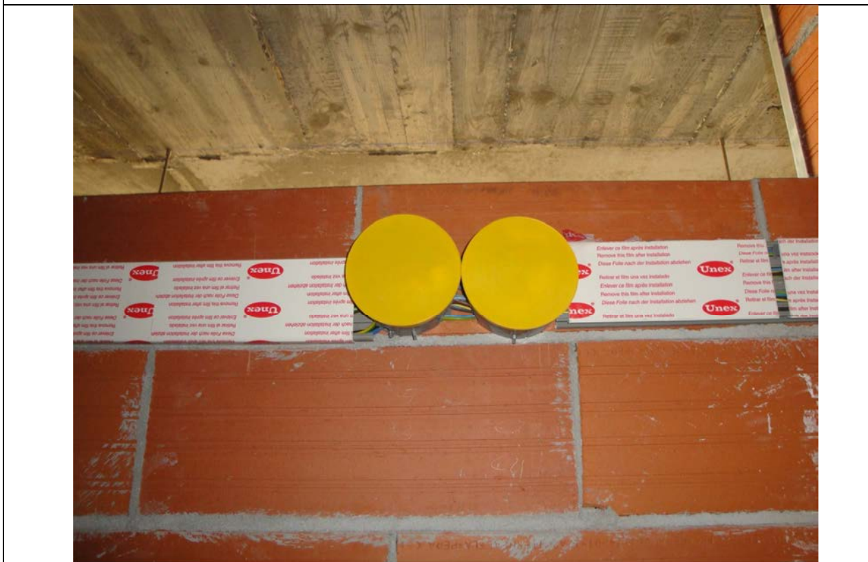
Fotografia 19: Caixes de connexió d'Unex de forma circular
