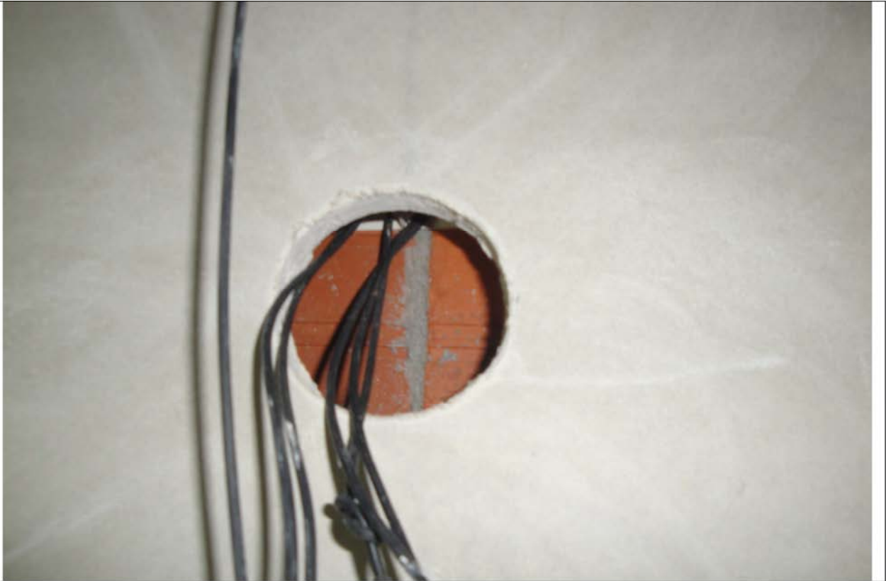
Fotografia 9: Perforació a la placa coincident amb el final de la canaleta.
