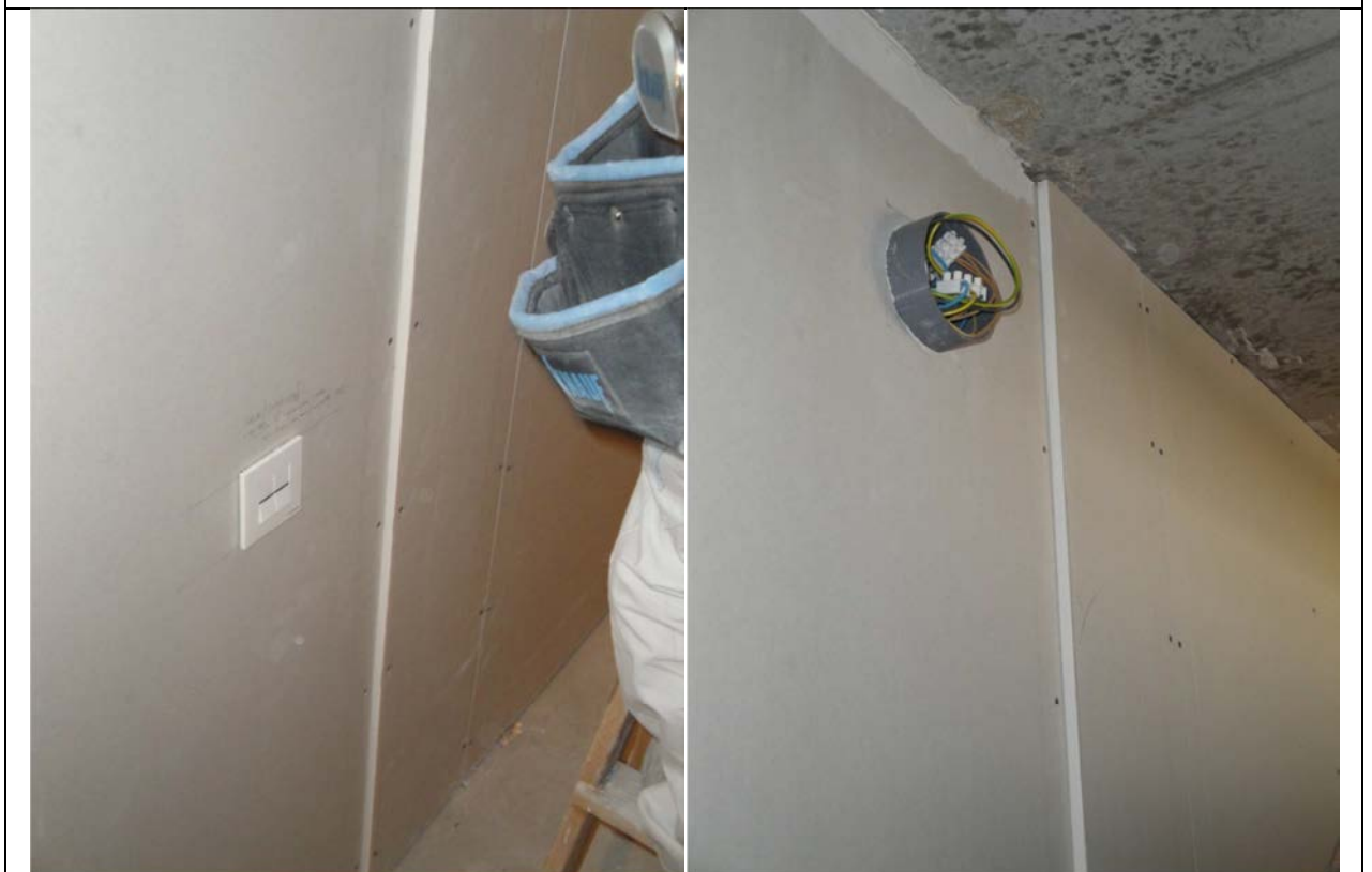
Fotografia 34: Ressalt de la PYL allà on hi ha aïllament reflectant.
