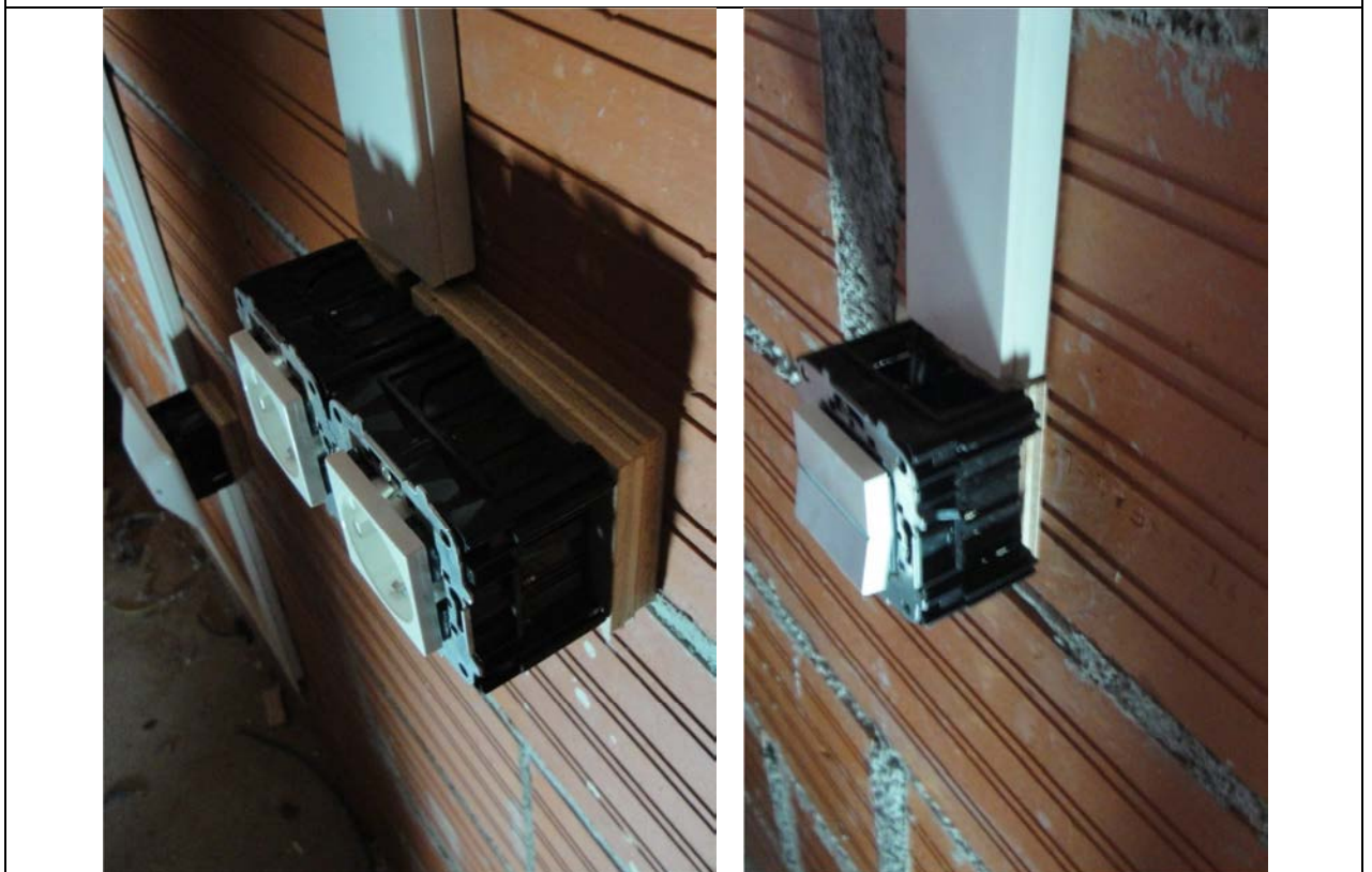
Fotografia 23: Suports de fusta dels mecanismes.
