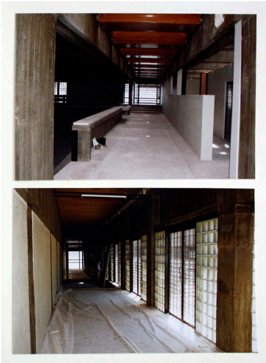
136. Fotografias da construção da igreja, já sob a responsabilidade do Secretariado das Novas Igrejas do Patriarcado, onde se podem ver as galerias
