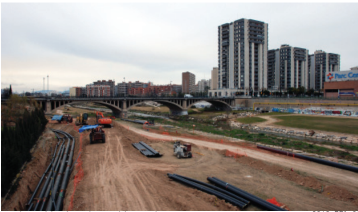
Conductos del rack en el cauce del Francolí
