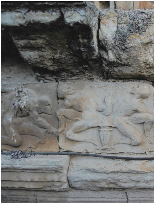
Figura 4. Detalle del estado de conservación de los sillares que componen el entablamento.
