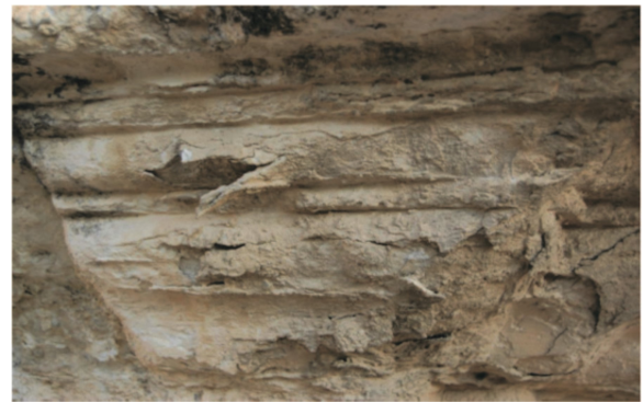
Figura 3. Detalle de la cornisa de arranque del tercer cuerpo. Su exposición al agua de lluvia favorece la migración de las sales que se encuentran en el interior del material pétreo hacia el exterior, en el proceso de secado. Este fenómeno ha provocado la aparición de ampollas y picaduras desvirtuando las molduras originales.
