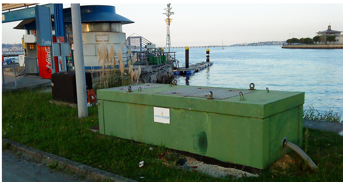
Fotografía 14: Estación de bombeo de las aguas hidrocarbonadas de Marina de Santander (Camargo).
