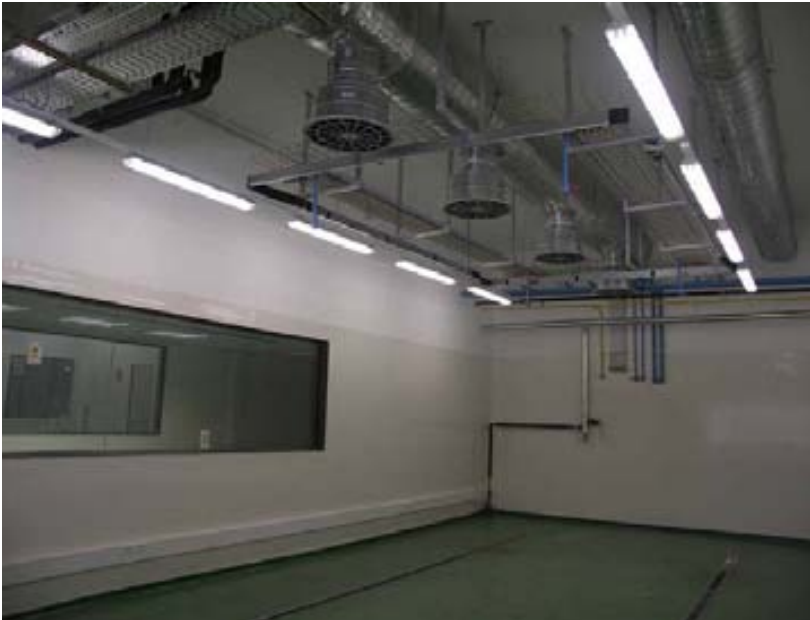
Figura 1.10: Instalaciones de la nueva Planta Piloto del proyecto MELISSA. Departament d'Enginyeria Química, Universitat Autònoma de Barcelona.
