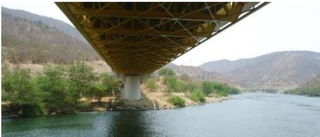
Figura 46. Aspecto del cauce aguas arriba del puente. Foto tomada por Apia XXI IMC 17/05/2013.
