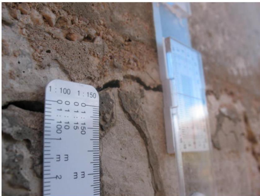
Figura 32. Monitor de fisuras en pila 4 del Viaducto Barranco del Chaparral (LAV Madrid-Zaragoza).
