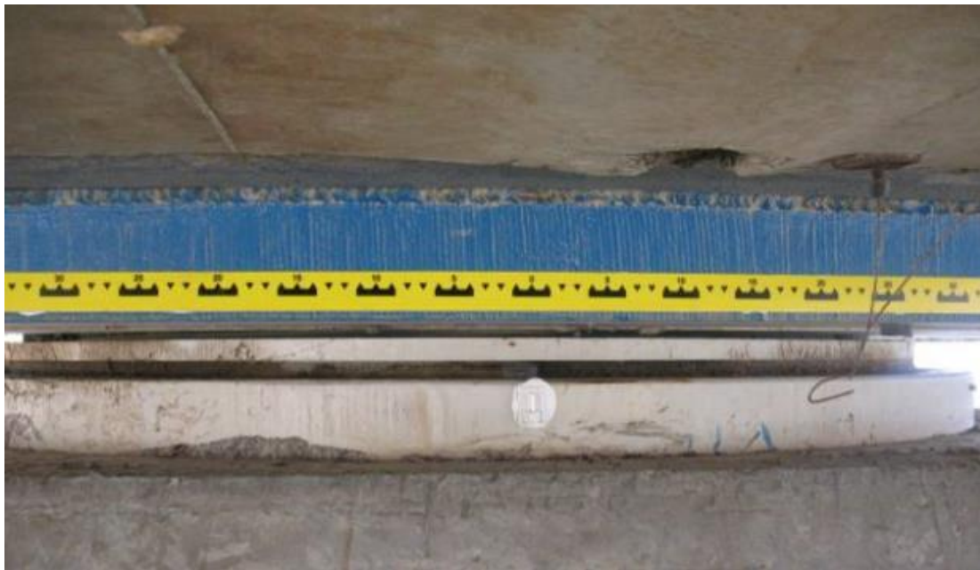
Figura 128. Regleta para el control del desplazamiento relativo tablero-pila. Viaducto sobre río Huerva. APIA XXI, S.A.
