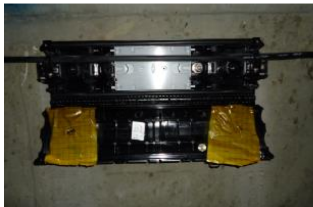
Figura 82. Detalle de anclaje de fibra óptica y caja de conexiones en tablero. Cortesía de Ineco.
