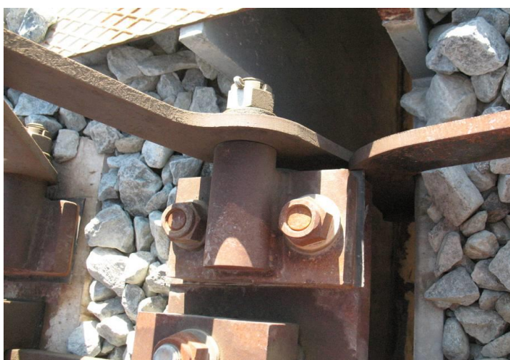
Figura 38. Aparato de dilatación de vía en estado de máxima capacidad. Viaducto río Guadalquivir (LAV Córdoba-Málaga).
