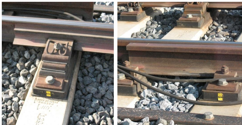
Figura 37. Referencias para el control geométrico de la aguja y contraaguja en el aparato de dilatación de vía del Viaducto río Huerva (LAV Madrid-Zaragoza).
