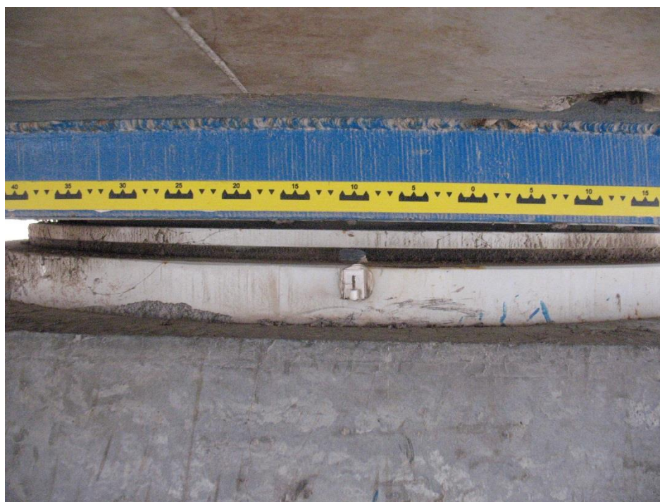
Figura 35. Monitor para el control del movimiento tablero-pila en Viaducto río Huerva (LAV Madrid-Zaragoza).
