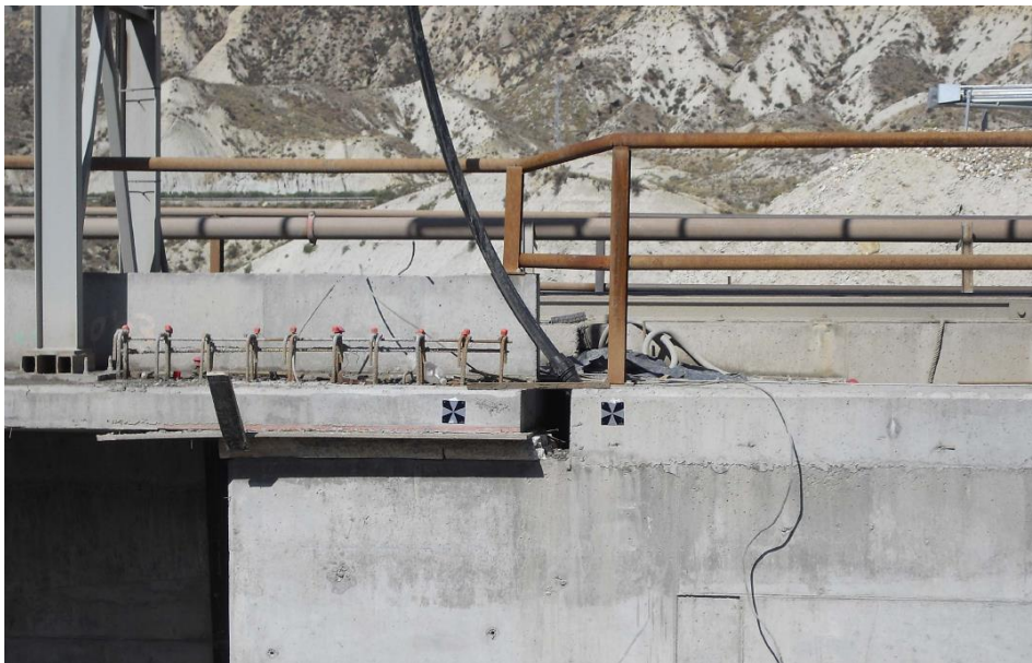
Figura 126. Dianas para el control del movimiento relativo tablero-estribo. Viaducto Río Aguas. APIA XXI, S.A.
