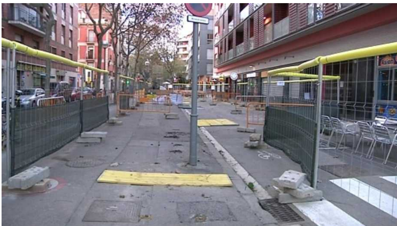
Fig. 6.47: Estado degradado del final de la Rambla. Fuente: Fem Rambla
