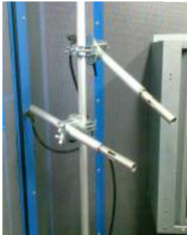
Fig.3.7: Sistemas de refrigeración indirecta en forma de lanzas de aire comprimido.
