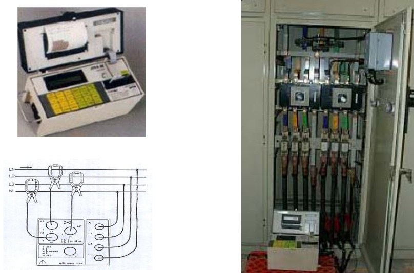
Fig. 3.6 Equipos portátiles de medición y esquema de conexión.
