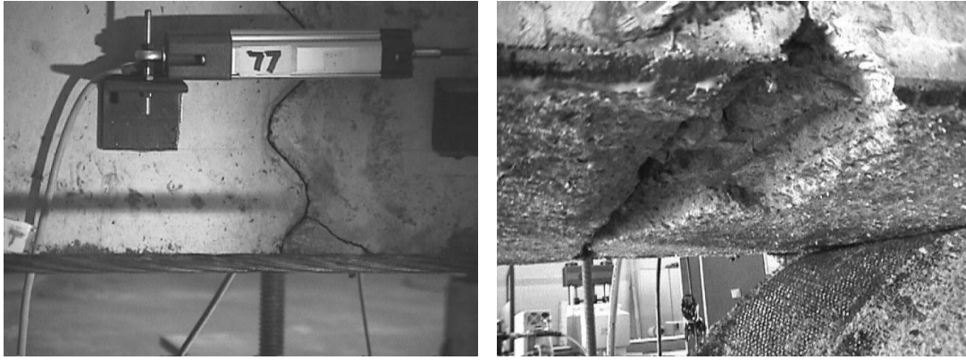
Figura 4.26. Detalle del despegue del TFC en la viga VD-TFC2; (Izq.) Fisuración inicial en la junta; (Der.) Desprendimiento del TFC.
