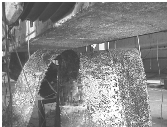
Figura 4.9. Desprendimiento del TFC en la viga VD-TFC2
