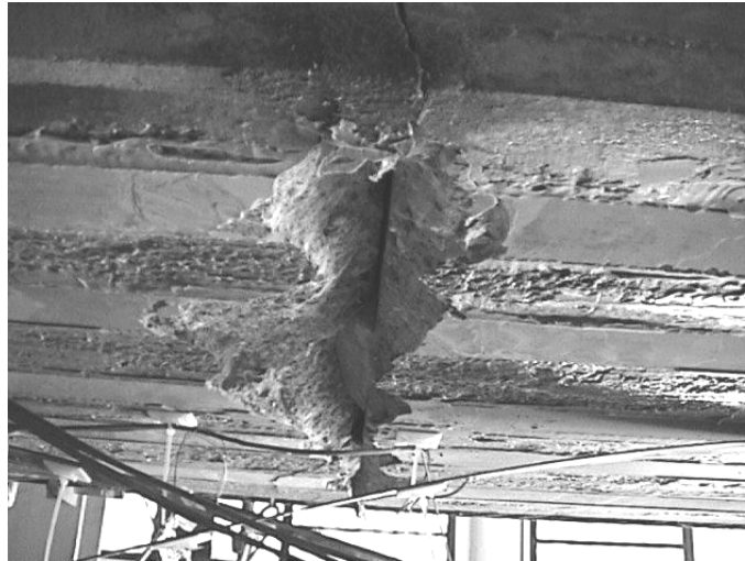
Figura 4.35. Detalle del desprendimiento del CFK en la viga VD-CFK1.
