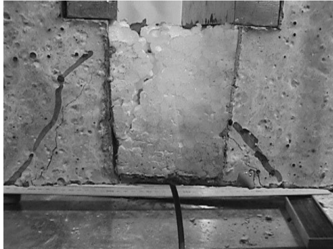
Figura 4.39. Detalle de la fisuración en la zona central de las probetas de adherencia.
