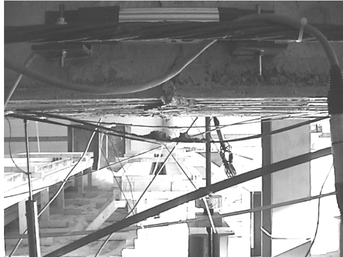
Figura 4.28. Detalle de la junta central entre dovelas después del ensayo VD-CFK1
