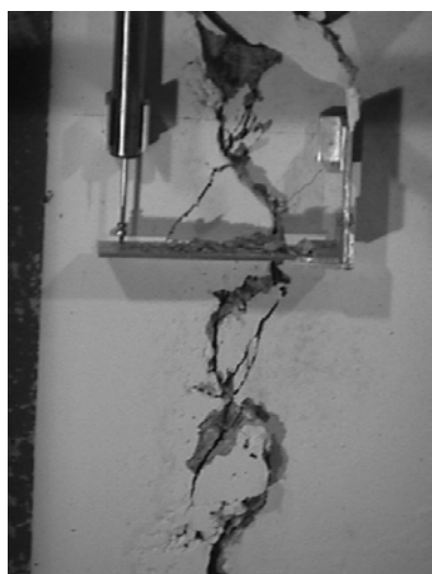
Figura 4.22. PC-JC. Estado en el que se encontraban las llaves en la fase de prerrotura.
