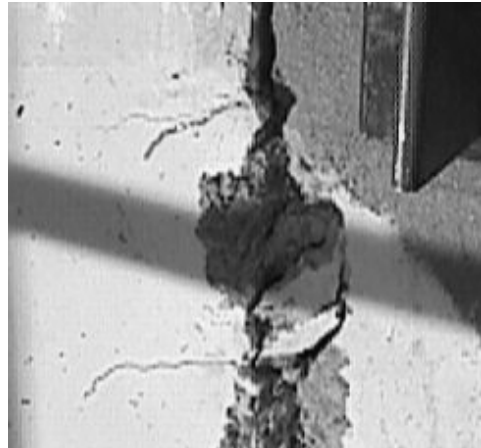
Figura 4.21. Detalle de la rotura de una llave PC-C-2.
