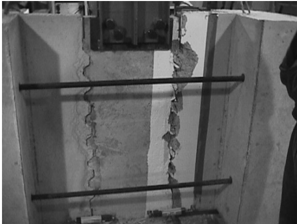
Figura 4.20. Rotura del panel PC-C-2.
