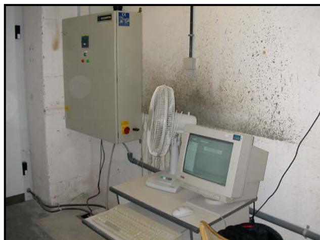
Figura 3.7.- Panel de control y ordenador
