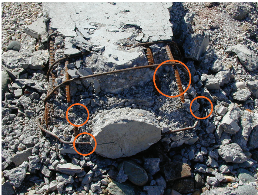
Foto 3.1 Fallo producido por la insuficiente ductilidad del acero longitudinal del pilar
