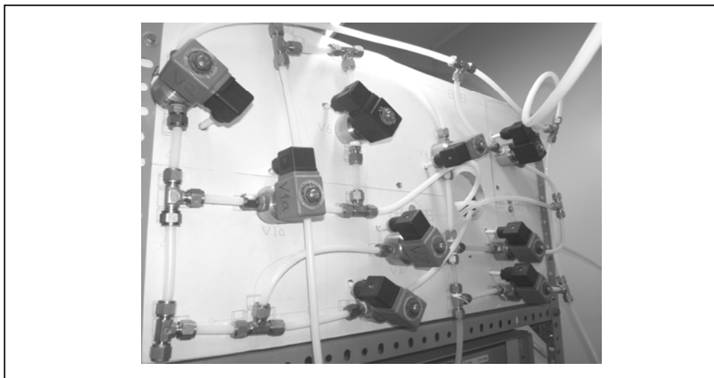
Fig. 3-7. Parte trasera de la instalación piloto actual.
