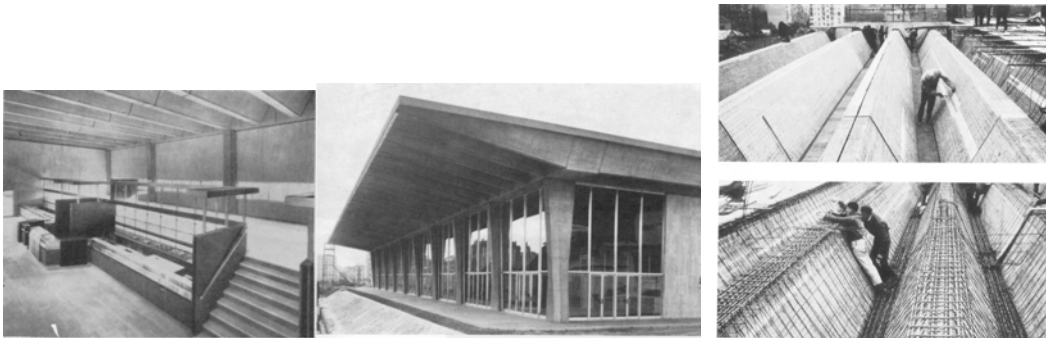
La cubierta plegada por debajo desde el interior y desde el exterior. Dos momentos de la construcción.
