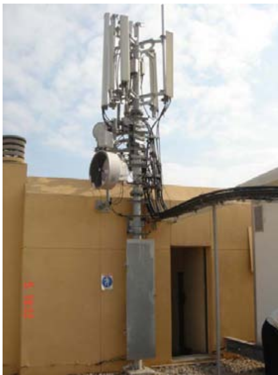
Imatge 97. Exemple de màstil on s'han instal·lat antenes per donar senyal dels dos
