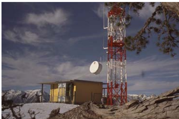
Imatge 110. Centre de Telecomunicacions de Montcaubó. Vall de Cardó (Pallars Sobirà). Centre amb torre de 25,00 m. En la imatge es pot observar el moment de l'enlairament d'una de les paràboles. Fotografia de l'autor. 05/08/1999.
