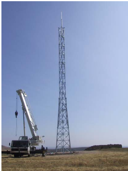
Imatge 133. Exemple de torre multioperador de 30,00 m d'altura, el dia del seu muntatge. Centre de Telecomunicacions de Fraga. Emplaçament ubicat al terme Municipal de Fraga (Aragó). Fotografia de Margarita Curto. 07/06/2001.
