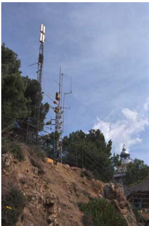
Imatge 112. Centre de Telecomunicacions de Tossa de Mar, Tossa de Mar (Selva). Centre petit de sala única amb torre de 12,00 m. Fotografia de l'autor. 18/06/1998.
