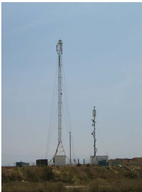
Imatge 101. Exemple d'estacions base provisionals instal·lades per donar cobertura a la zona del Fòrum de les Cultures, que nou mesos més tard continuen sense ser desmantellades. Instal·lacions ubicades a la Ronda del Litoral, a l'altura dels edificis del Fòrum, a la ciutat de Barcelona (Barcelonès). Fotografia de l'autor. 05/06/2005.
