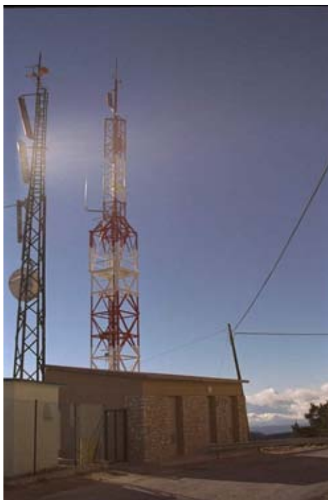
Imatge 111. Centre de Telecomunicacions de Sant Llorenç de Morunys. Terme municipal de Guixers (Solsonès). Centre mitjà amb tres sales i torre de 20,00 m. Fotografia de l'autor. 18/06/1998.
