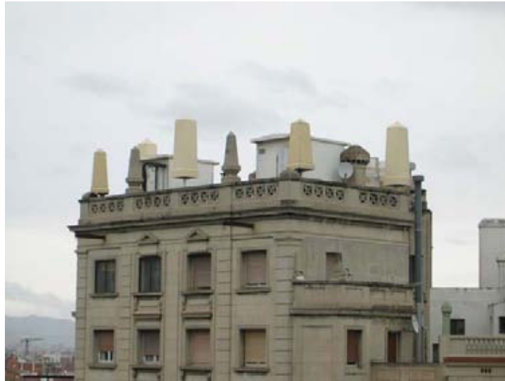
Imatge 128. Exemple de protecció externa (tipus radomo), per a dos operadors. No es un exemple que s'hagi executat amb cura. Instal·lació ubicada al carrer Marina, núm. 212, cantonada Consell de Cent, núm. 504, a la ciutat de Barcelona (Barcelonès). Fotografia de l'autor. 09/12/2004.
