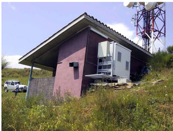
Imatge 56. Instal·lació en modalitat Outdoor. Centre de Telecomunicacions de Setcases, al terme municipal de Tregurà de Dalt (Ripollès). En aquest cas la edificació estava correctament integrada en el paisatge, i amb posterioritat es va adossar un nou equipament (Amena). Fotografia de Xavier Alonso. 06/07/2000.
