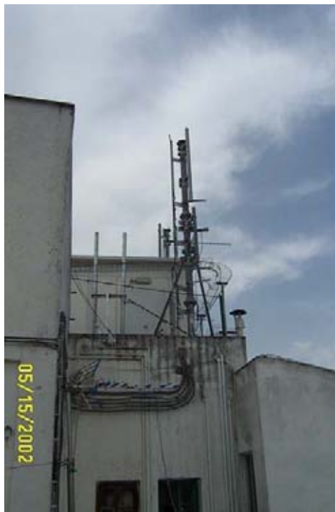
Imatge 84. Instal·lació de màstils, satèl·lits i antenes en la coberta d'un edifici de la ciutat de Sevilla (Espanya). Cadascú fa el que més li convé. En aquesta cantonada de l'edifici a
