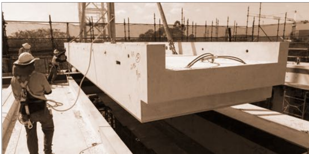
Fig. 4.2.1 Pieza estructural prefabricada de geopolímero a base de ceniza volante - Queensland's Global Change Institute (GCI) University - Australia (2013).
