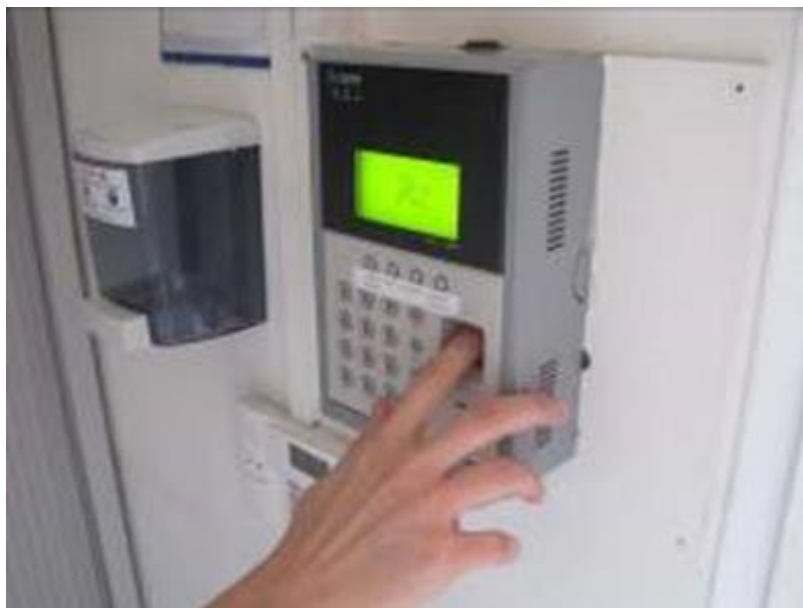
Figura 3.21 Puerta de acceso restringido mediante fichaje.
