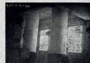
435.V.4-54 Edificio de Tratamiento Químico. Vista de dos alimentadoras de alumbre instaladas en el primer piso.
