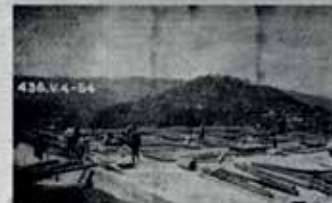
436.V.4-54 Poniendo los encuentros para la losa del techo del compartimiento oeste; en el primer plano se ve la losa del techo del compartimiento este terminada.
