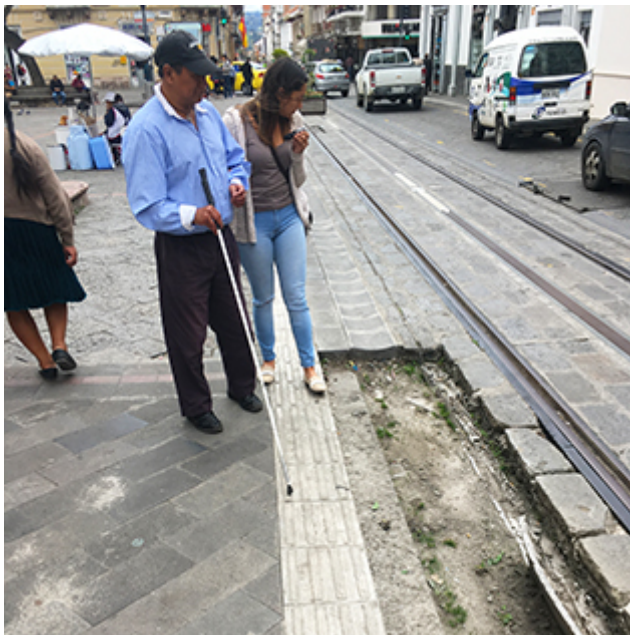
Ilustración 20. Manuel en el Centro histórico. Se aprecia una banda podotáctil al filo de un hueco junto a los rieles del tranvía. Foto del autor (2018).
