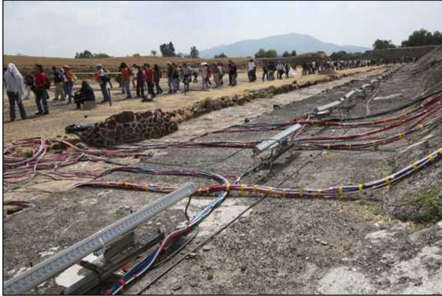
Figura 48. Detalle de las instalaciones eléctricas en la Pirámide del Sol. Fuente: La Jornada (Rodríguez, 2009c).
