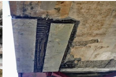
Figura 5-11 Detalle lateral e inferior de los trabajos de saneo realizados, en zona de muy alta densidad de armado.
