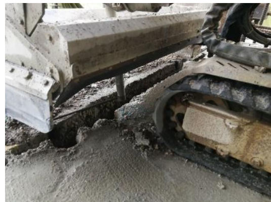
Figura 3-12 Ejemplo de corte de forjado mediante agua a presión y posterior corte de armado con oxicorte. (INGETURARTE).
