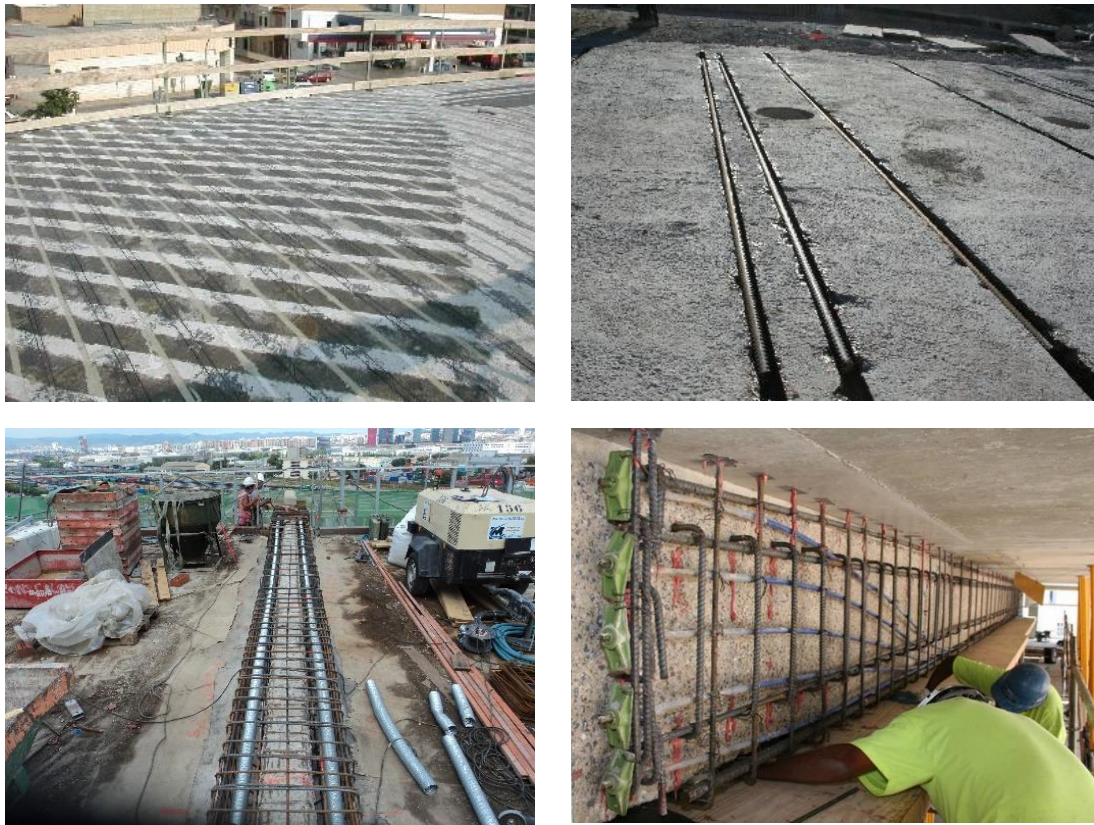
Figura 1-17 Ejemplos de refuerzo colaborante (a) (b) combinación de NSM con barra de acero y laminados de fibra de carbono, (c) postensado adicional multicordón adherente con recrecido (VSL) y (d) postensado unitario no adherente (SPS).
