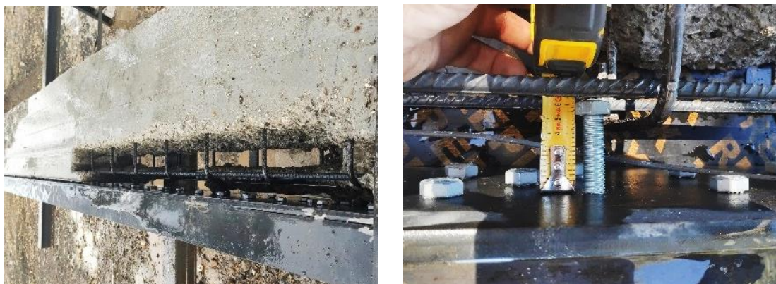
Figura 2-5 Secuencia constructiva con apertura de roza (a), e inserción de conectores (b).
