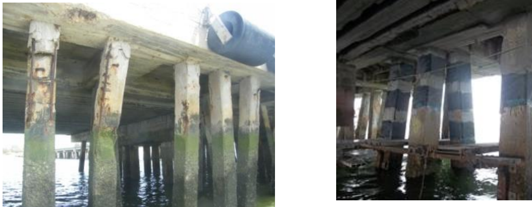
Figura 2-9 Refuerzo de pilas-pilote en pantalan (a) Antes del refuerzo (b) Reparación y refuerzo con CFRP.
