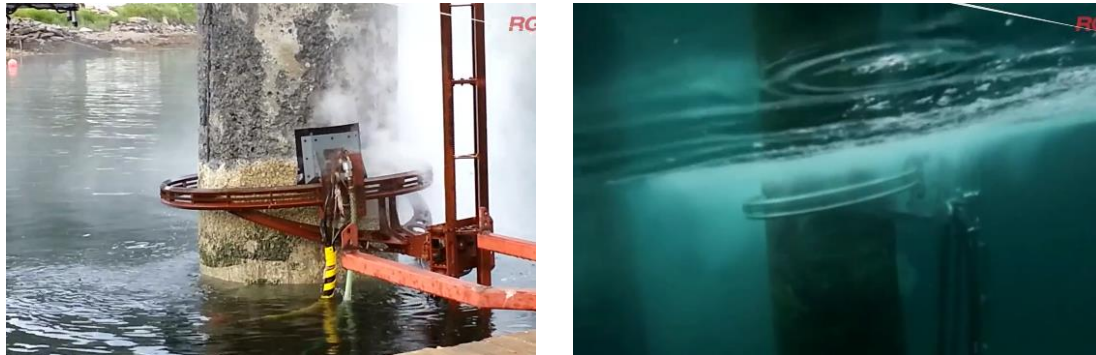
Figura 3-39 Vista de robot automatizado demoliendo recubrimiento en pila de puente (a) Tramo aéreo (b) Tramo sumergido (Rglservices.co.uk).
