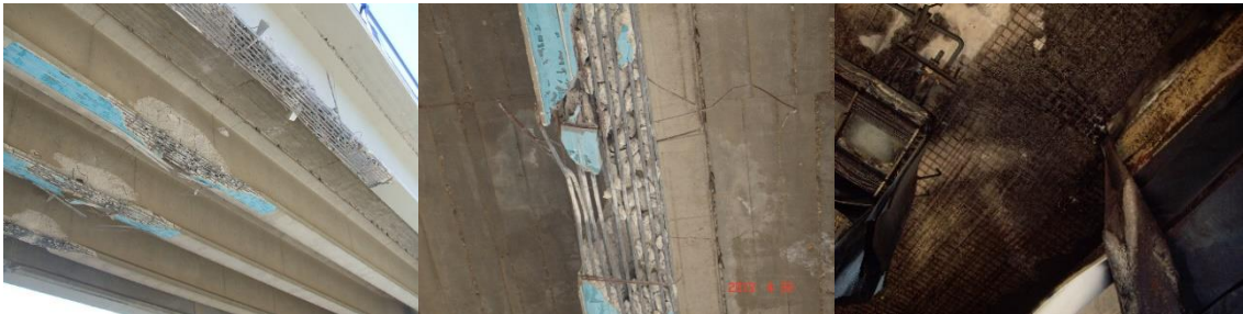
Figura 4-36 (a)(b) Pérdida de refuerzo colaborante adherido en viga de puente por impacto (c) Pérdida de recubrimiento en forjado tras incendio.
