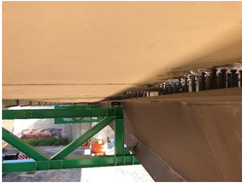
Figura 4-13 Vista de detalle de paramento superior de la viga con los conectores a punto de ser insertados en la losa de hormigón, izando la viga.
