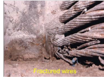
Figura 1-12 Zona de anclaje con alambres dañados. (Matthews, 2007)
