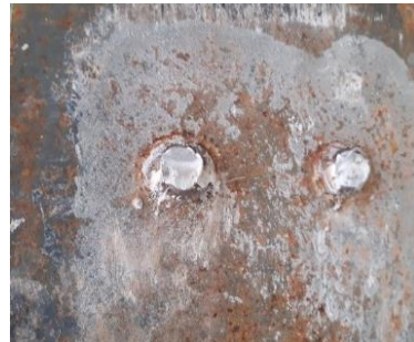
Figura 5-27 Conector a cortante y compresión, con fallo por rotura en el vástago.
