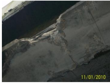
Figura 1-10 Impacto en viga de puente en paso superior con afectación de cordones
