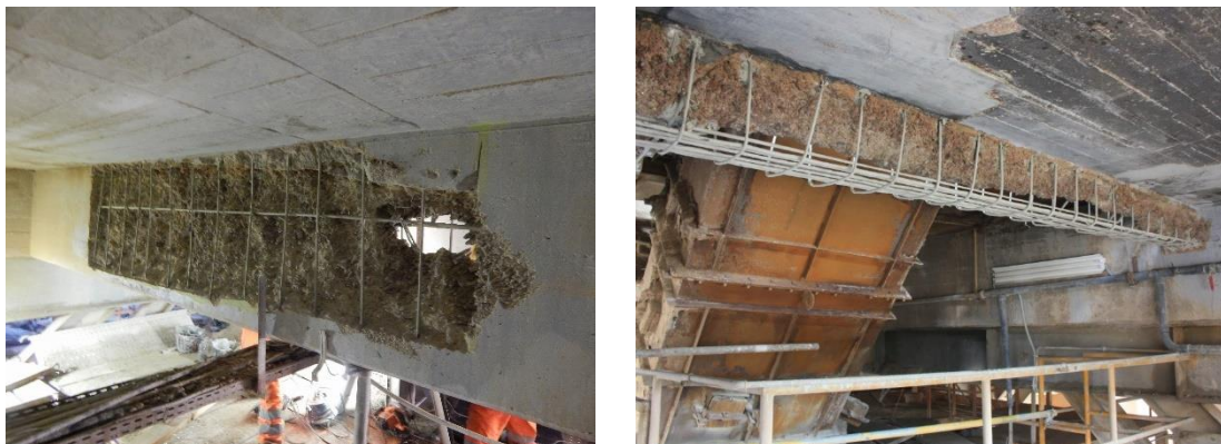
Figura 4-35 Agresividad en la demolición ante patologías internas en el hormigón.
