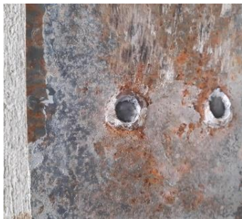
Figura 5-26 Conector a cortante y tracción, con fallo por soldadura.
