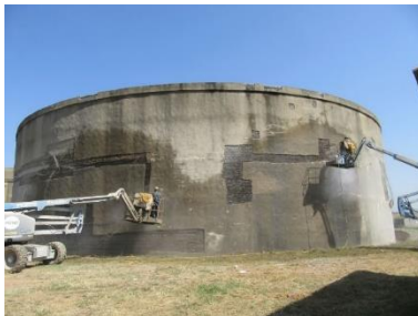
Figura 5-3 Vista general del depósito pretensado a sanear para su reparación y refuerzo
