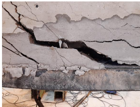
Figura D-7 Secuencia de rotura para viga #3.
