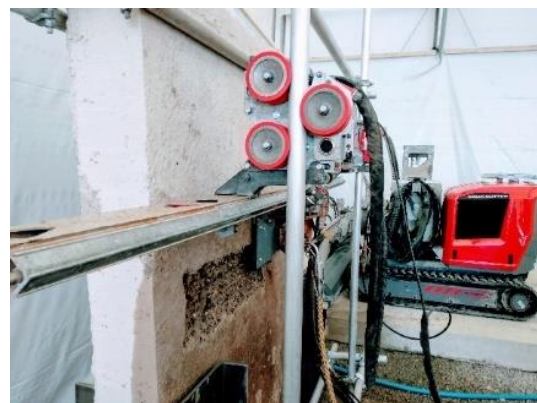
Figura 3-2 Vista de los robots que movilizan las boquillas para la demolición controlada.
