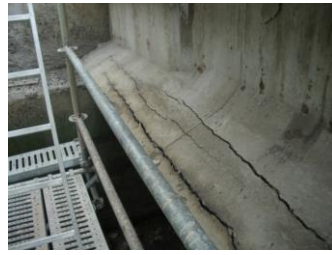
Figura 1-11 Daño por corrosión en viga carrilera de puerto por cloruros.
