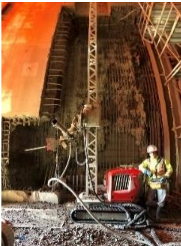
Figura 3-32 Equipo de UHP desplazándose sobre marco tubular.
