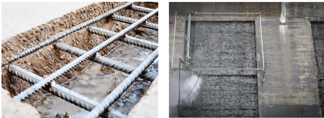
Figura 3-41 (a) Detalle del paramento con corte de árido, trabajando a muy alta presión y bajo caudal. (b) cajeado en paramentos
