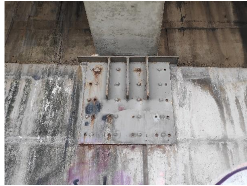
Figura 3-56 Ménsula metálica con numerosos anclajes químicos (no instalados) por interferencia con armado base.
