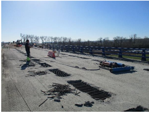
Figura A-11 Retirada mediante oxicrote de la armadura que interfiere a los nuevos conectores.
