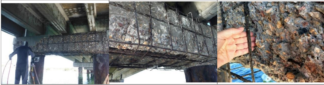
Figura 2-6 (a) Saneo para restauración de dintel en pantallón (b) Armadura vista y desvinculada soporte (c) Alta rugosidad y solidez del soporte.
