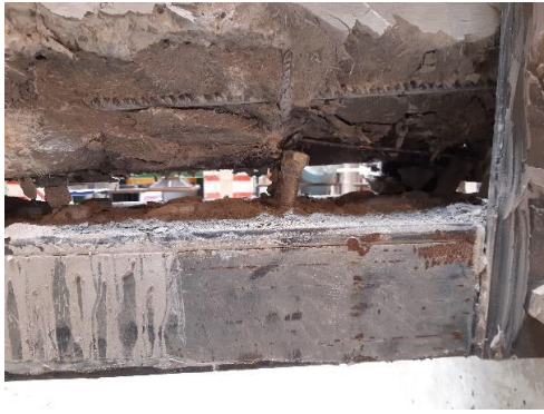
Figura D-10 Secuencia de rotura para viga #2.
