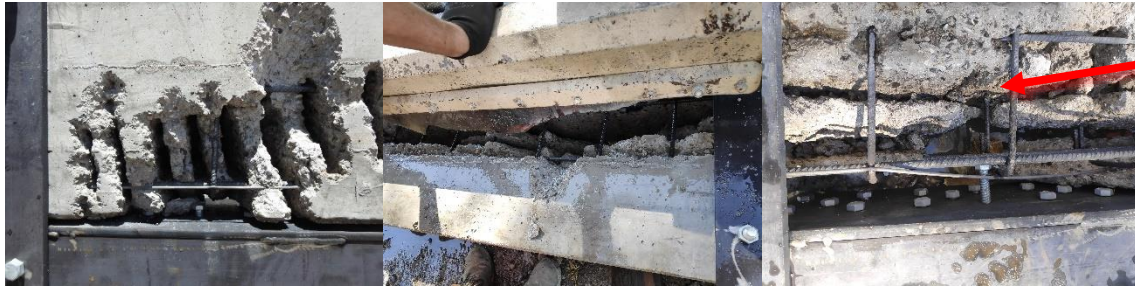
Figura 5-53 Errores de programación del cabezal generando daños en la primera viga: (a) demolición fuera de rango (b) y (c) generación de lajas fuera de contorno.
