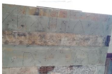
Figura 5-9 Vista de las pletinas a macizar por coqueras en el trasdós.
