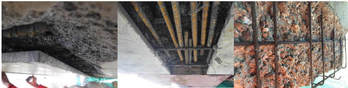
Figura 3-42 Detalle de matriz de hormigón tras demolición con agua a 3000 bar (20l/min): (a) (b) matriz de hormigón poco porosa (c) matriz de alta porosidad.
