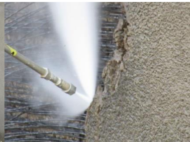
Figura 5-5 Detalle de la boquilla y el chorro de agua, con retirada de hormigón en zona interior a los alambres.
