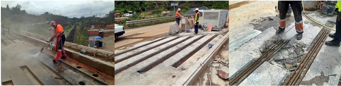
Figura 5-6 Vista general de los trabajos de saneo con agua a presión, tras un cajeo por corte inicial y repicado.
