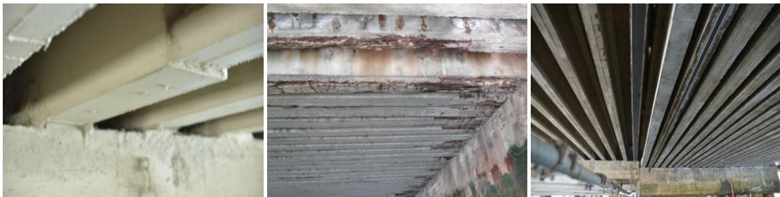
Figura 2-10 (a) Daños en vigas pretensadas con afectación a alambre pretensado (b) Tras el saneo y refuerzo con CFRP.
