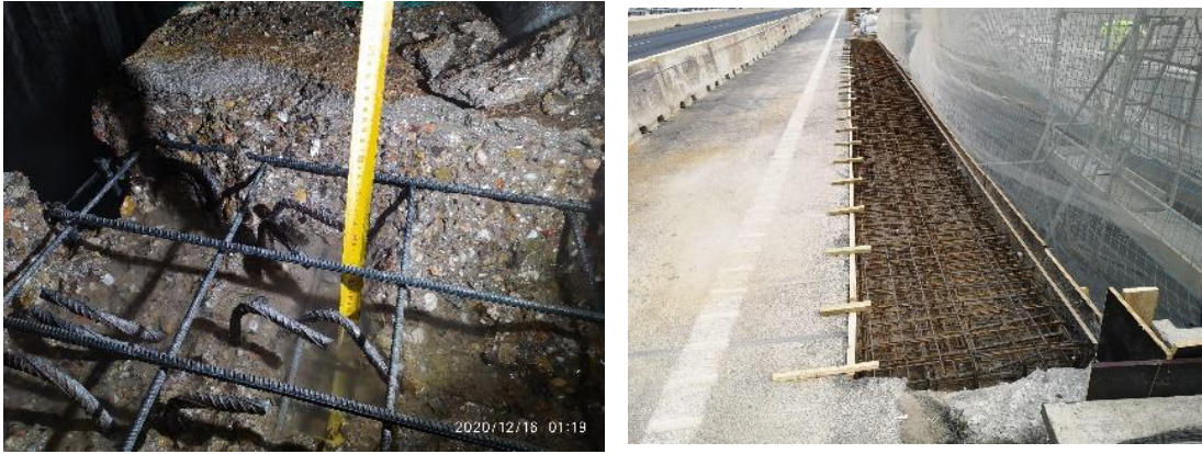
Figura 3-9 Secuencia de apertura de losa de tablero para instalación de nueva barrera de contención (NESCO).
