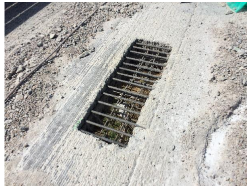
Figura A-10 Detalle de la apertura en espesor total de la losa de tablero. Se aprecia la totalidad de la armadura sin daño ni desplazamientos.
