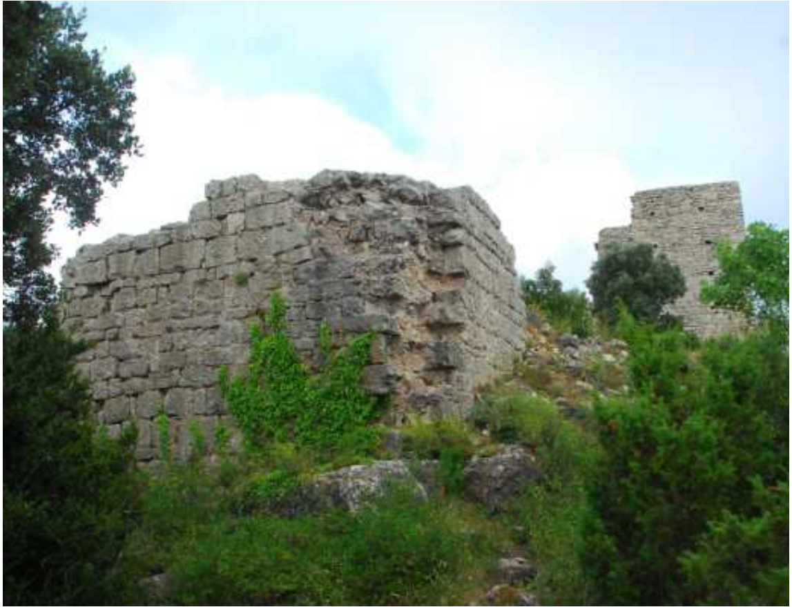
FIGURA 11.76: vista de la construcció al nord de la torre, formada per filades de carreus de llarg i través assimilables als aparells califals. Al fons, la torre restaurada.
