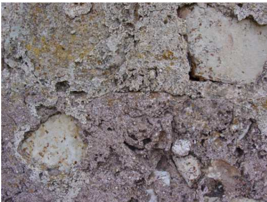
FIGURA 11.60: diferència de tongada de tabiya de la torre del castell, la inferior és amb morter vermellós i la superior blanquinós.
