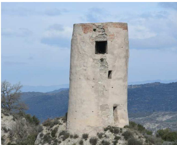
FIGURA 9.19: torre albarrana de Castellfollit de Riubregós. La intervenció realitzada fa uns anys ha emmascarat un sistema constructiu molt semblant a les torres de Vallferosa i Lloberola (J. A. Adell).
