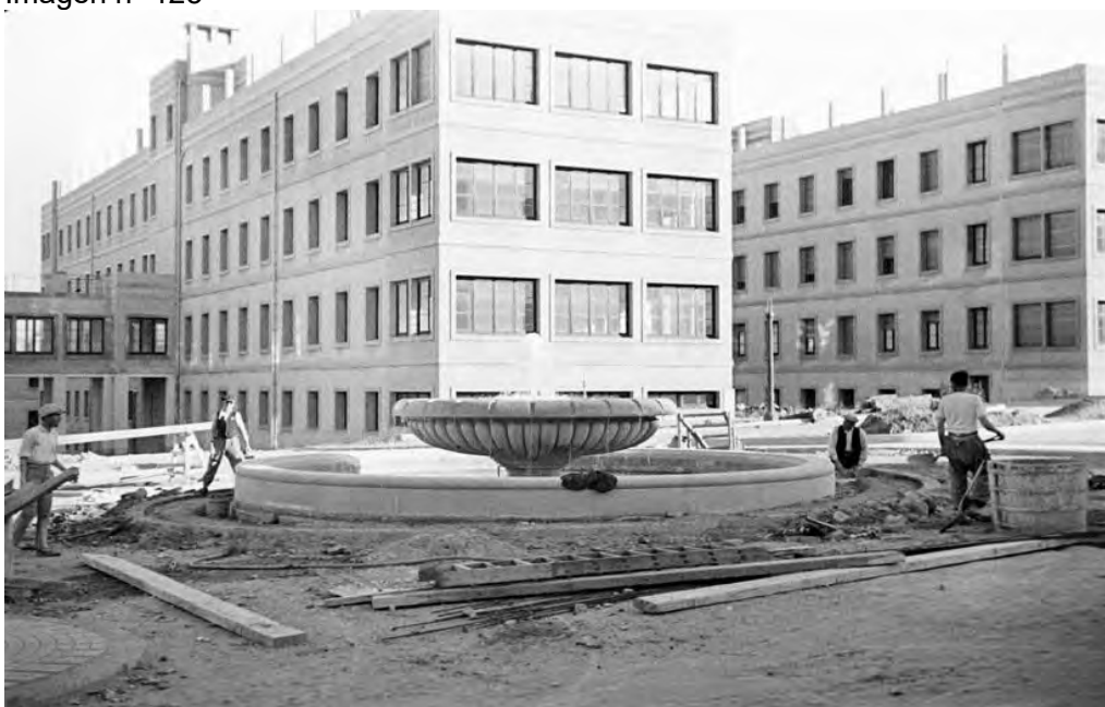
H.M. del Generalísimo - Hospital en construcción (Plaza central con su fuente) Pabellones, detrás. Fuente: ANC1 - 42 - n -34785 - firma 000068(3) T. (1-4) – Desde el 01.03.1939 al 31.12.1942
