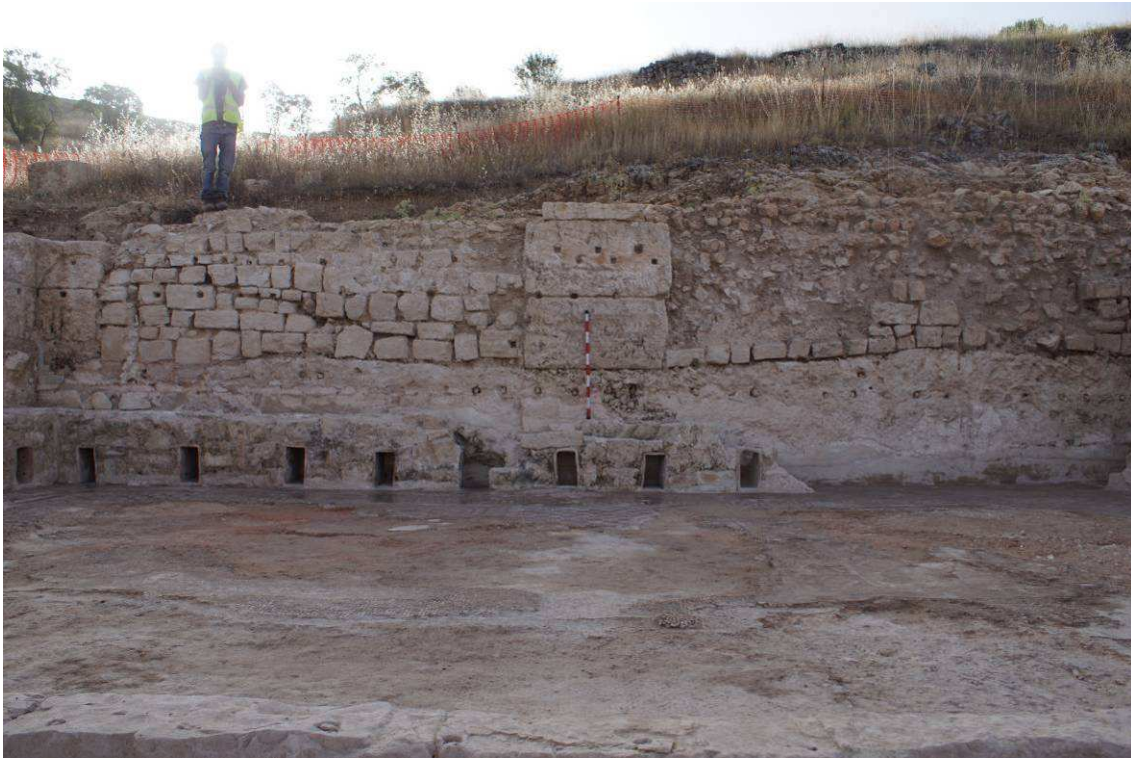
Figura 100. Vista del estado de conservación del CF-5 desde el punto central del apodytherium . Fotografía del autor.
