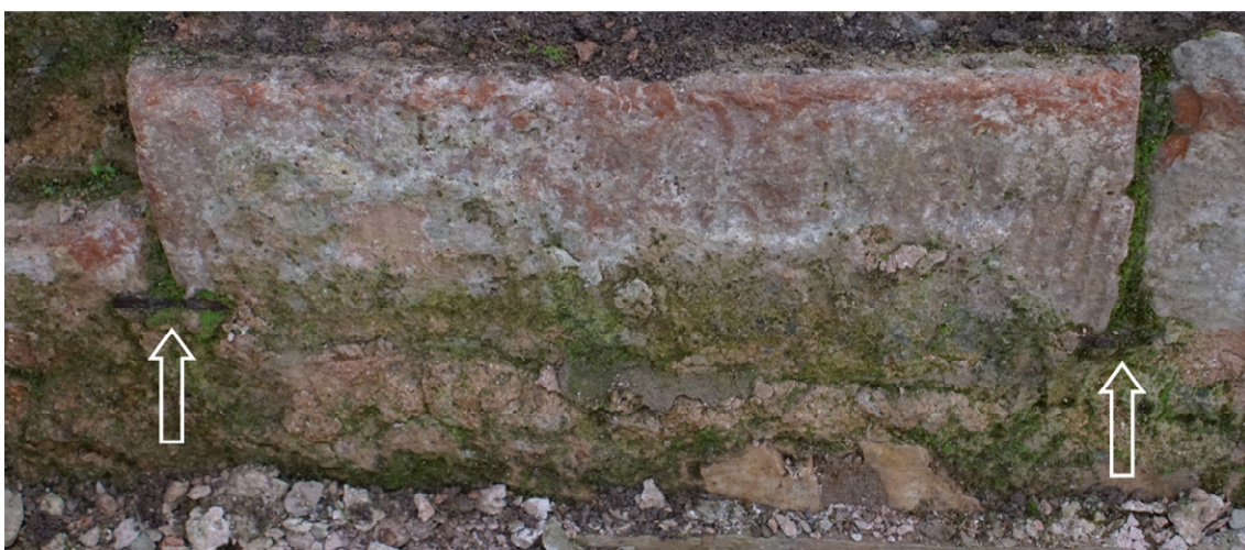
Figura 83. Vista de la disposición de los ladrillos de regularización de la piscina. Las flechas señalan la posición de las grapas metálicas que unen y solidarizan las piezas cerámicas entre sí. Fotografía del autor.
