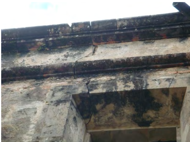
11). Importante fractura localizada en un vano de la fachada norte.
