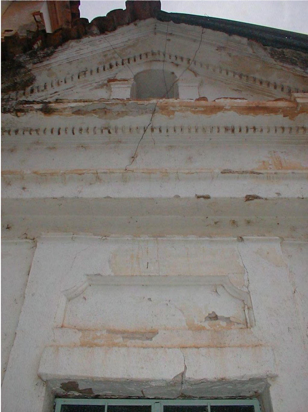
29.) Detalle del estado actual del dintel y frontón del salón de catecismo.
