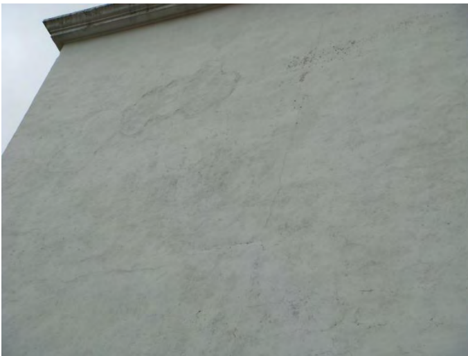
7). Abultamiento y fisuras del enjarre bajo el campanario.
