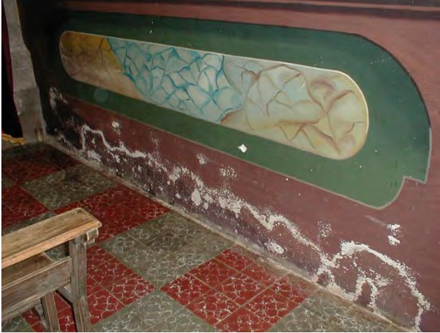
32). Se puede observar las eflorescencias.
