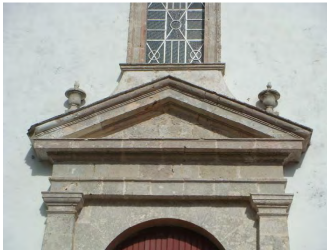
4). En esta imagen se puede apreciar la fractura que desciende desde la ventana superior.
