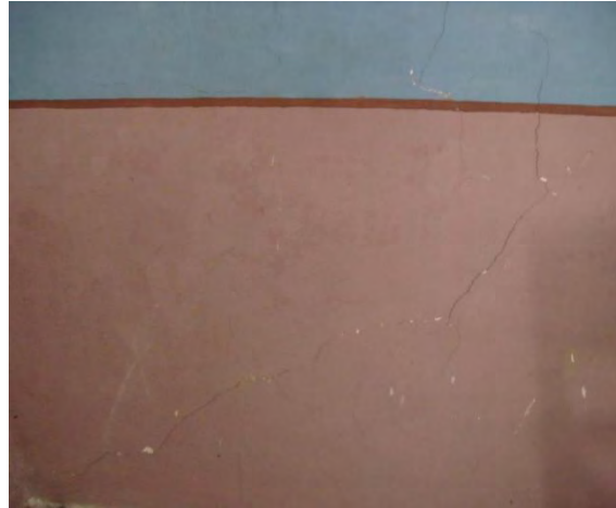
6). Detalle de grieta en la pared poniente del coro.
