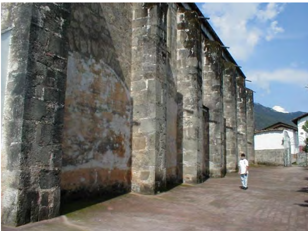
34). Se puede ver que el asoleamiento de la fachada sur no evita las manchas de humedad. (Fotografía del 2002).
