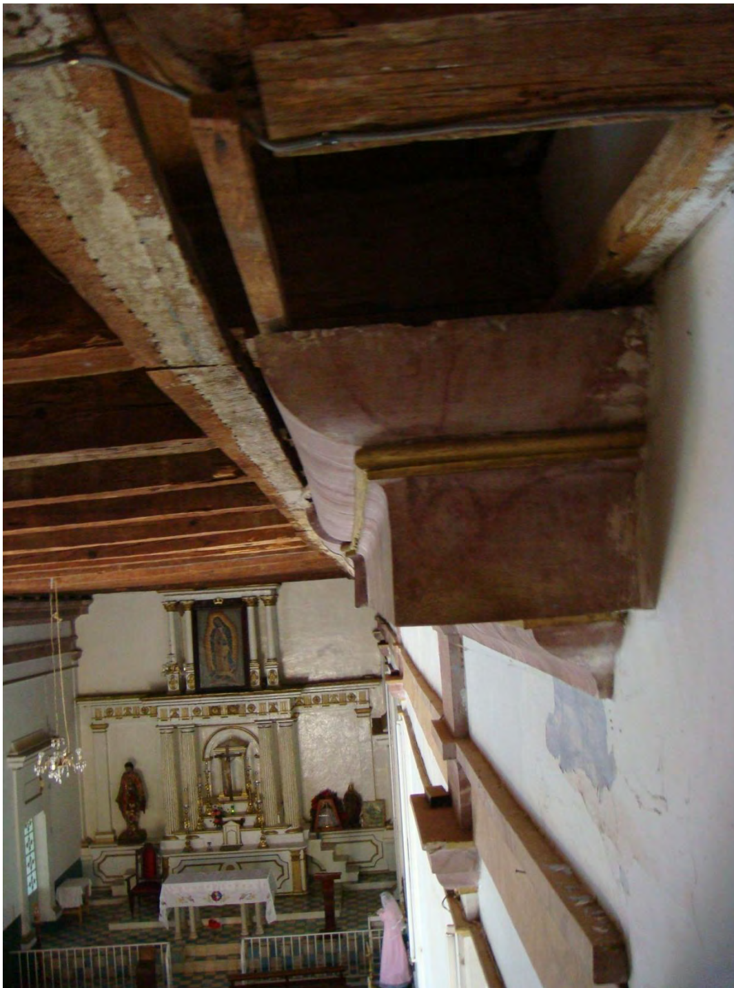
18.) Detalle de las ménsulas de la cubierta del templo. Nótese el aspecto tan deplorable de las vigas y las grietas bajo la ménsula.
