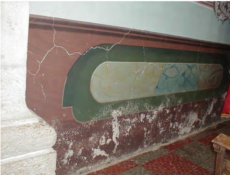
15). Grietas y humedades en la parte interna del muro.
