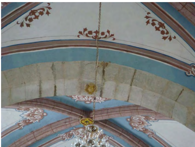
38). Juntas resanadas con morteros ricos en cemento.
