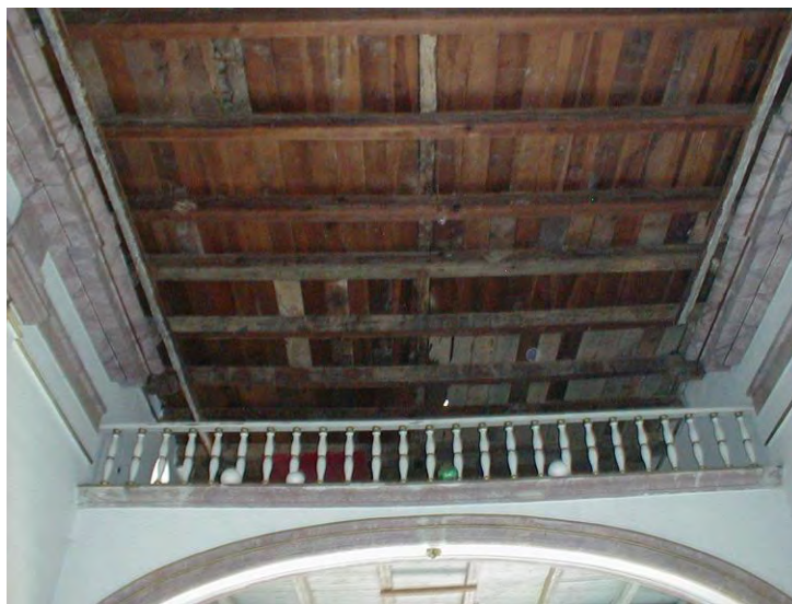
38.) Detalle del tejamanil 4 que se encuentra inmediatamente después del coro hacia la cubierta superior. Nótese el ladrillo, las vigas y las fajillas.
