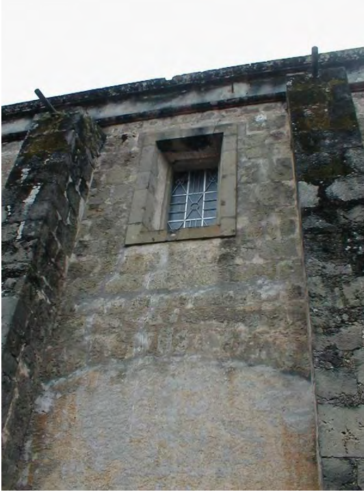
16). Presencia de musgo y hongos en los contrafuertes.
