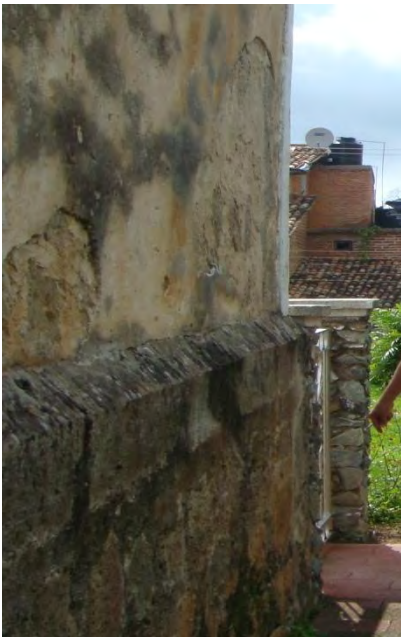
20). Detalle de descascaramiento de enjarre y presencia de hongos..
