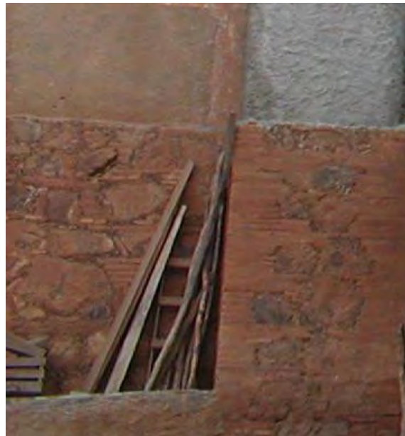
5.) Detalle de la nivelación por la parte oriente, nótese el color rojizo de la arcilla.
