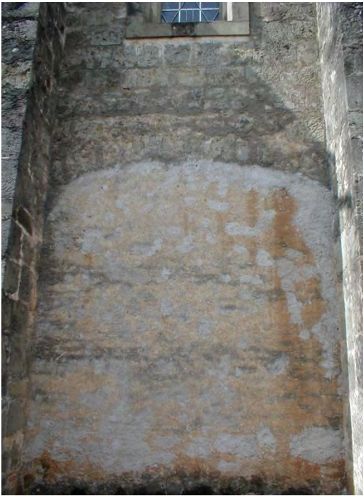
17). Humedades en el muro. Se puede ver el cambio de coloración.
