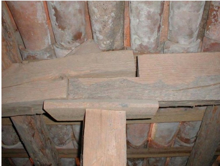
15.) Se puede observar el detalle del traslape de los largueros o vigas de la cumbrera, en la cubierta principal de la única nave de esta iglesia y el estado actual de los materiales.
