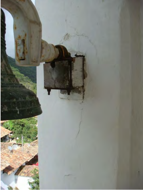
55). Detalle del empotramiento y grieta vertical.
