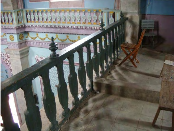
46). La grieta continúa a ambos lados de la trabe.
