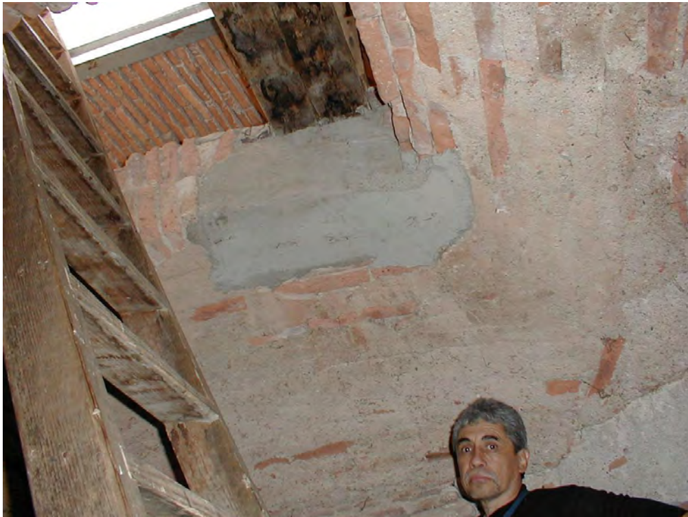
32.) Detalle de escalera, bóveda mixta y aún más arriba, podemos apreciar un añadido posterior de bóveda de cuña y viga de acero, para encuadrar la apertura de la escalera vertical.
