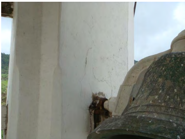
53). Grietas por encima del mechinal.
