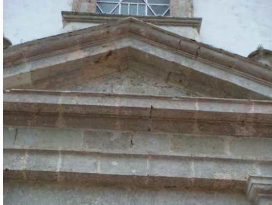
3). Obsérvese la fractura del lado derecho del frontón.
