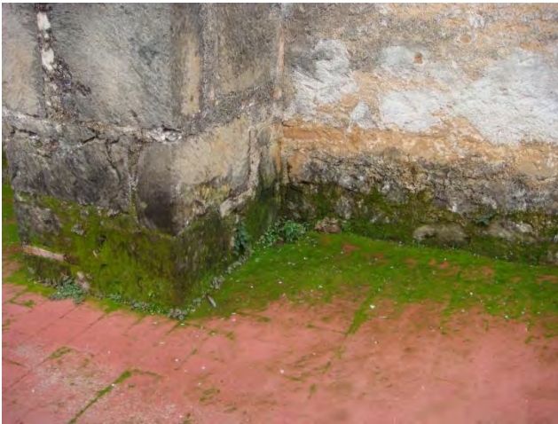
33). Detalle de las humedades.
