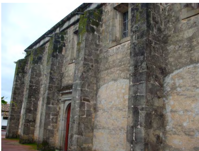
30). Presencia de musgo en arranque y coronación de los contrafuertes.
