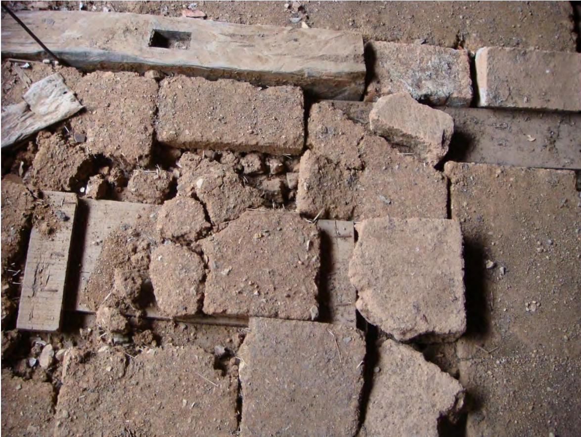
19.) Detalle del entepiso de terrado o tejamanil, se aprecian las fajillas de madera donde se apoya y el estado actual de cómo se encuentran algunas zonas.
