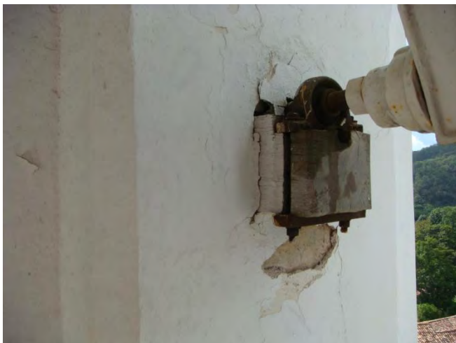
54). Se puede observar el desprendimiento del enjarre bajo el mechinal.
