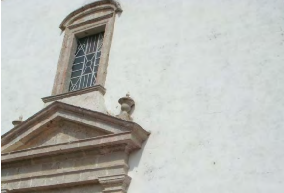
5). Fisuras en el muro poniente. poniente del coro.
