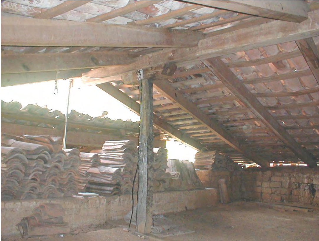
15.) Detalle de la cubierta hacia el lado poniente. El sobrepeso se apoya en el pretil.
