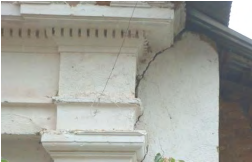
Evidente separación de muros hacia el sur.
