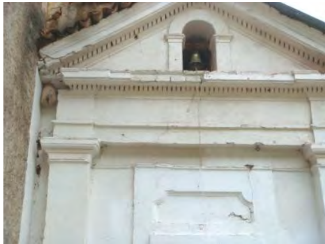
Grietas y fracturas muy evidentes hoy en día.
