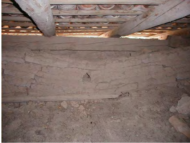
20.) Colapso de pretil en Santa María.
