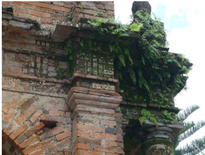
59.) Detalle de deterioros en el pórtico de Los Reyes.
