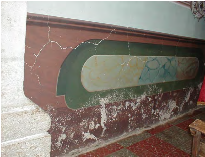
12.) Grietas y humedades en la parte interna del muro norte.
