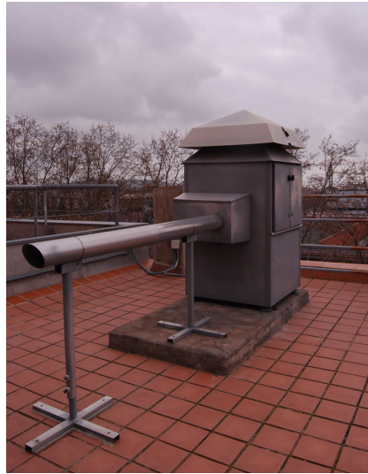
Figura 43: Vista general del equipo de alto caudal
