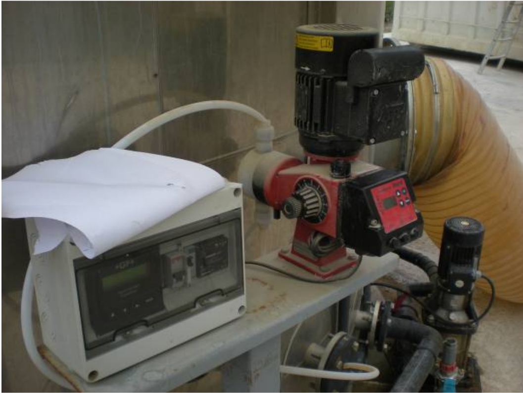
Sistema de control de pH y dosificación de sulfúrico en la base del scrubber
