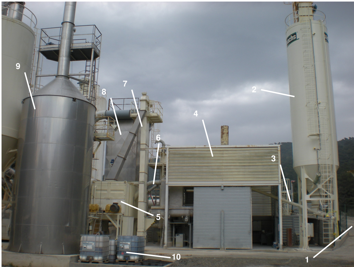
Figura 3.10. Vista global de la planta Alchimix terminada
