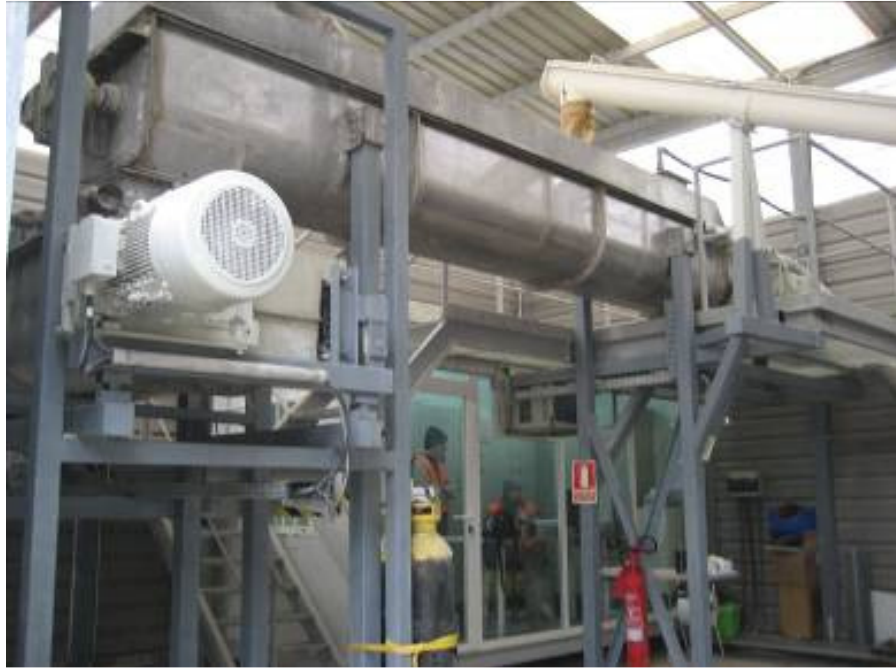
Reactores de mezcla antiguos
