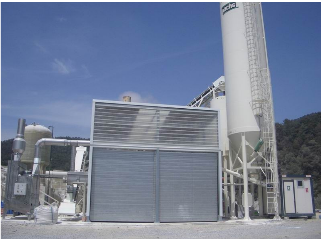
Planta de tratamiento concluida en su configuración inicial
