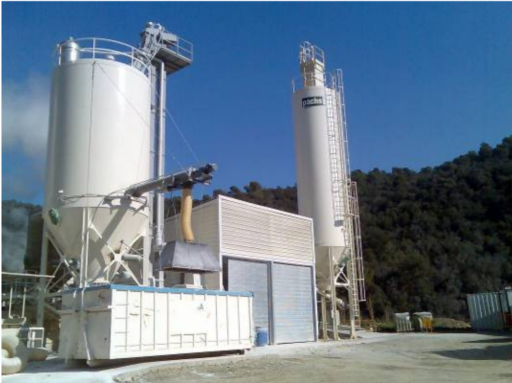
Aspecto de la planta antes de las reformas efectuadas en 2008
