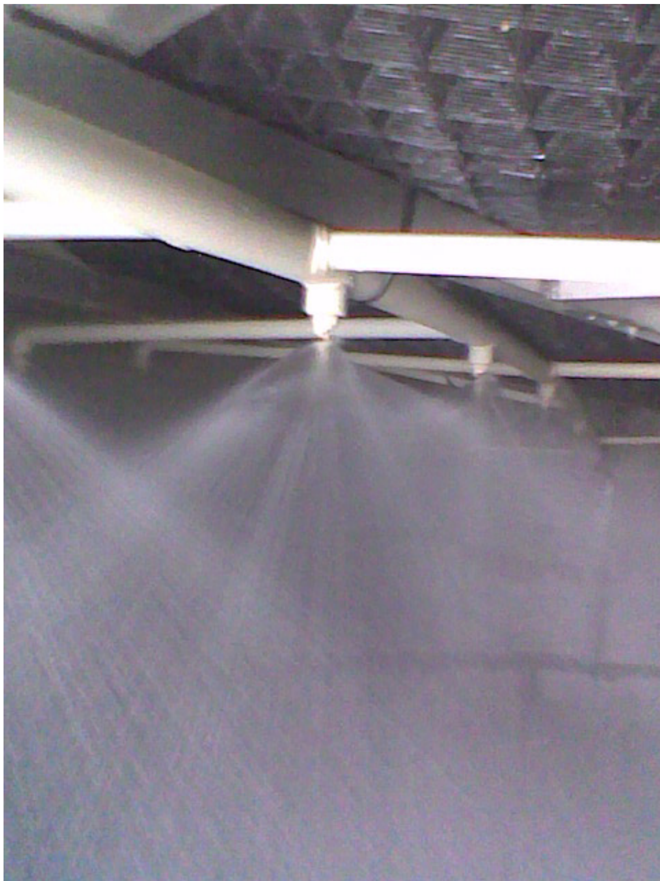
Interior del scrubber (rociadores y separador de gotas)
