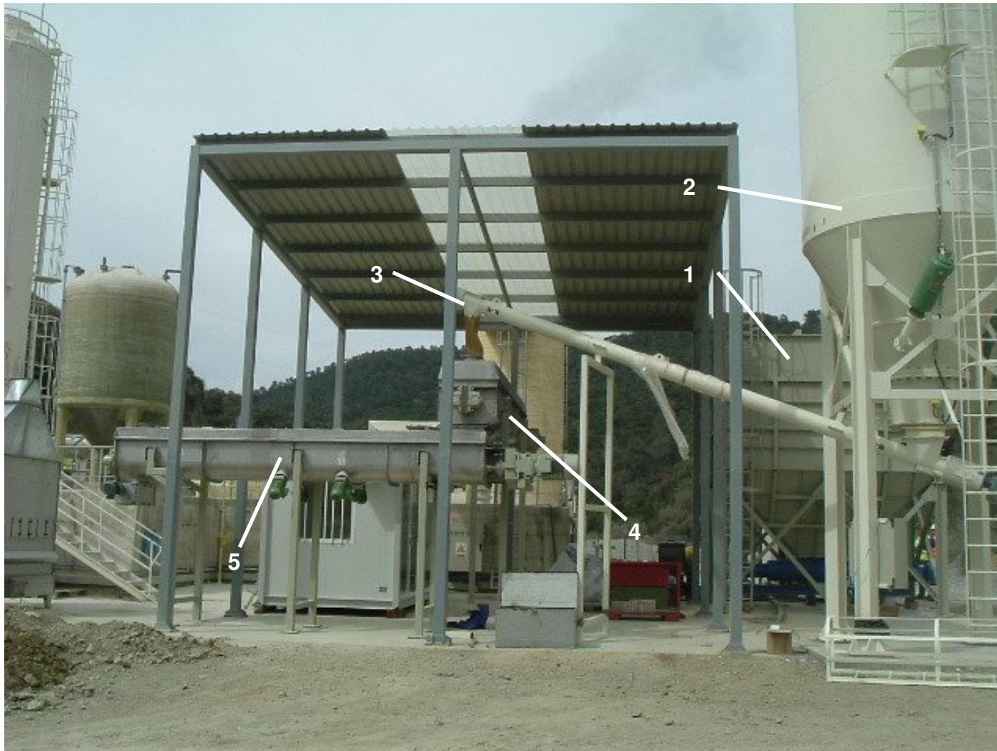
1. Tolva de recepción de fangos EDAR; 2. Silo de CaO; 3. Dosificación de CaO al final de la unidad premezcladora; 4. Unidad premezcladora; 5 Reactor de mezcla intensa basado en MID-MIX.
