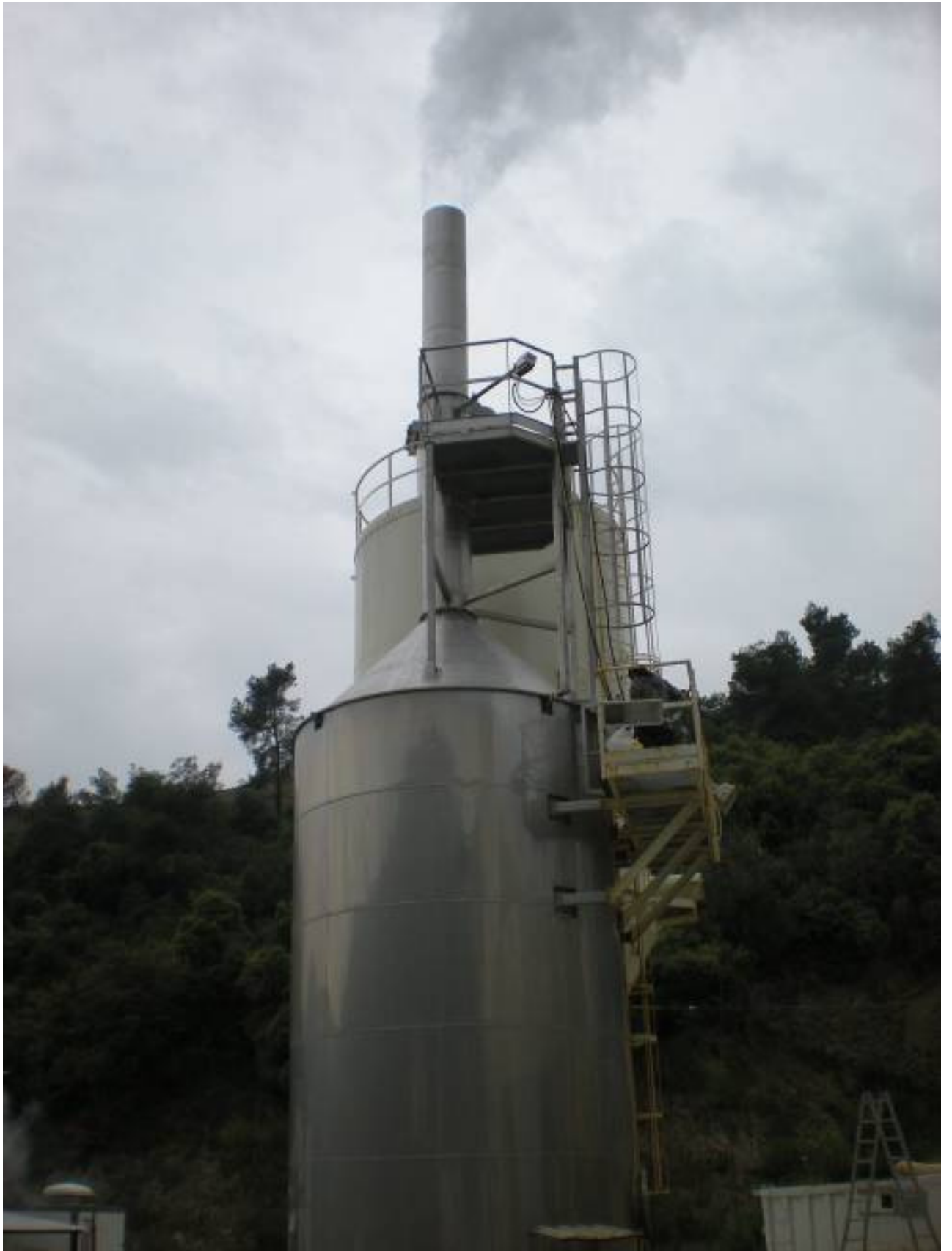
Planta en funcionamiento. Nuevo scrubber con chimenea adaptada para toma de muestras con sonda instalada (ver sobre plataforma).
