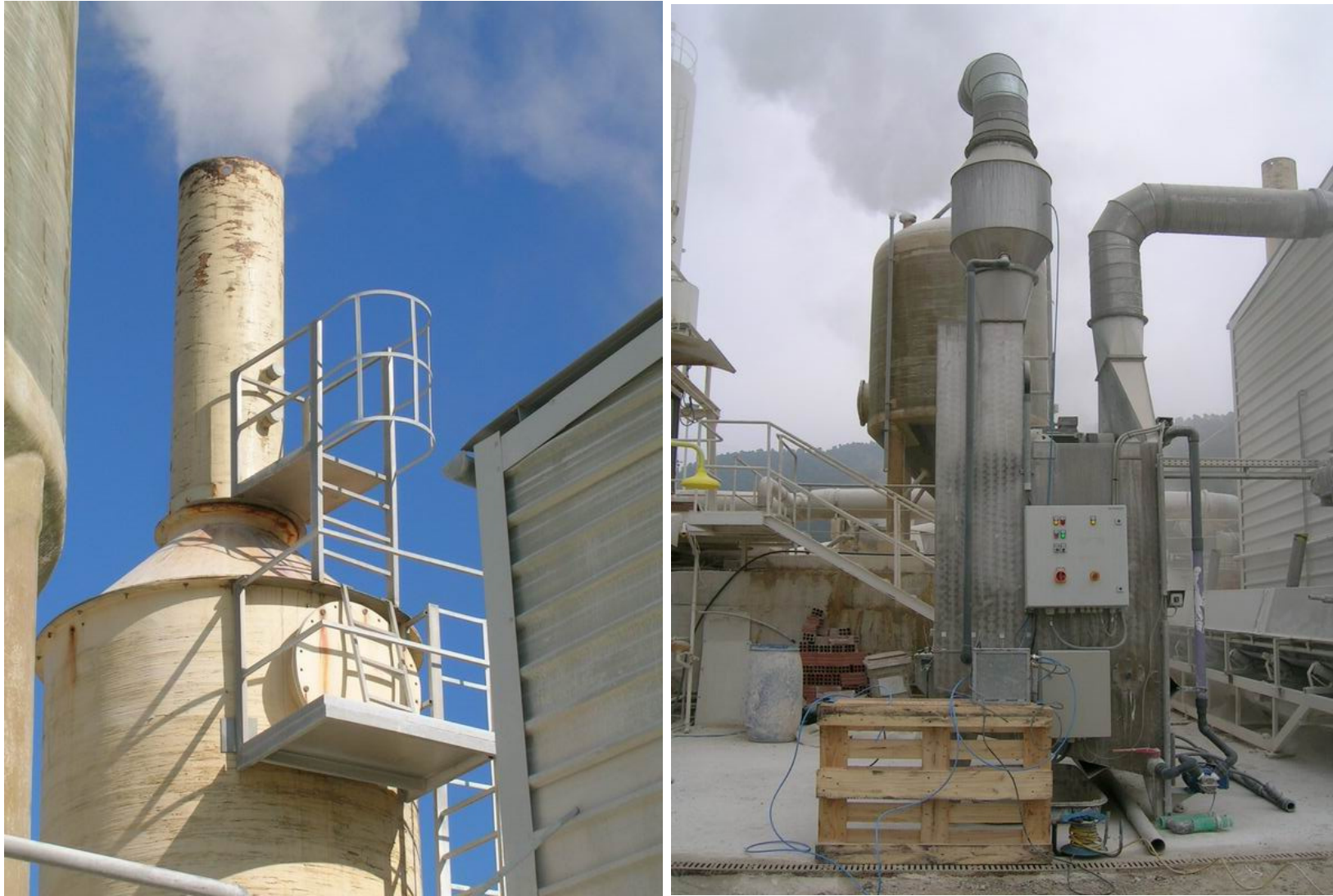
Plataforma construida en el antiguo scrubber para eventuales tomas de muestras (izquierda) e instalación de toma de muestras gaseosas a la salida del filtro de partículas (derecha).
