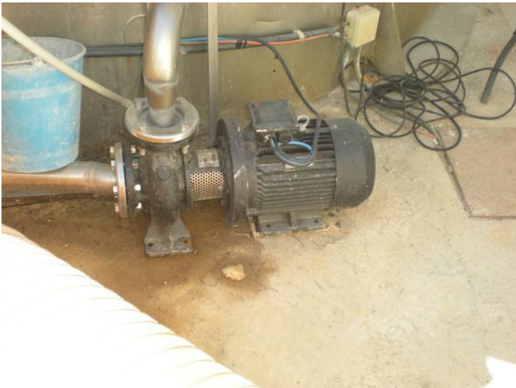
Nueva bomba de recirculación en la base del scrubber
