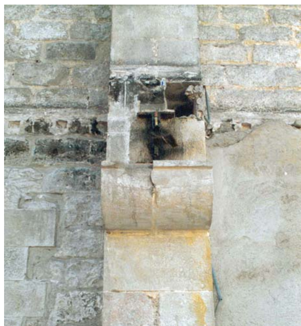
Els permòdols i els pilars varen ser malmesos pel forjat metàl·lic.
