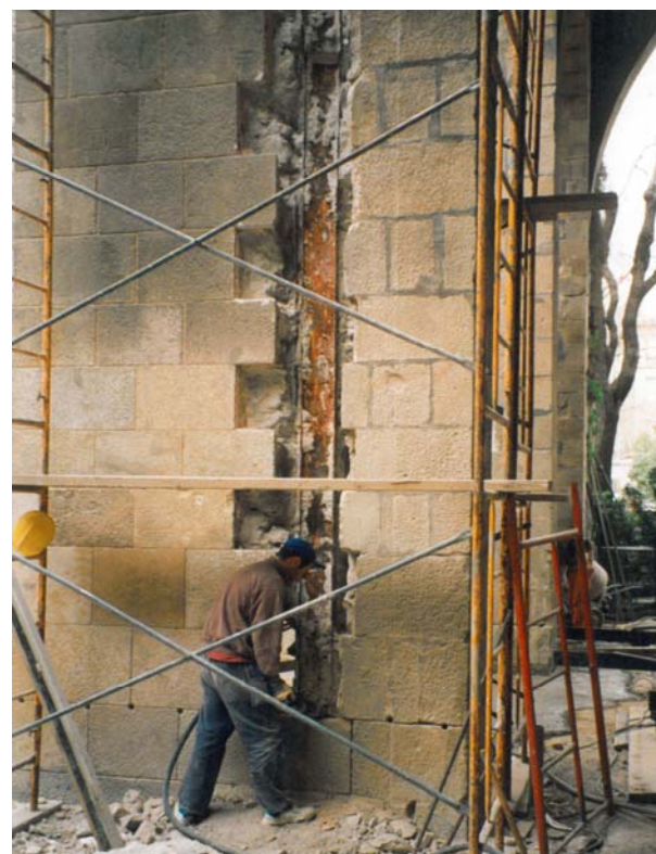
Perfils en doble T rovellats que treballaven en volada.
