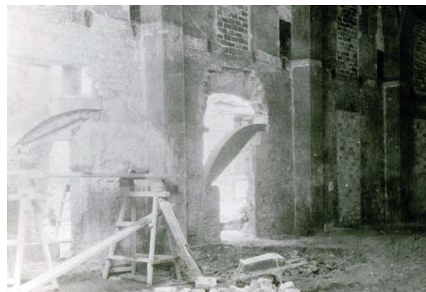
Els arcs del pòrtic de Pere II en reconstrucció. Vegeu la cintra per a bastir els arcs del pòrtic de Pere II.
