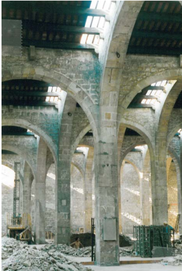
Proves realitzades in situ per tal de comprovar la quantitat de llum que entrava per les lluernes. En aquest cas l'amplada de les lluernes era de 3 línies de teules disposades en el sentit de les arcades diafragmàtiques (Arxiu Terradas Arqtes.).
