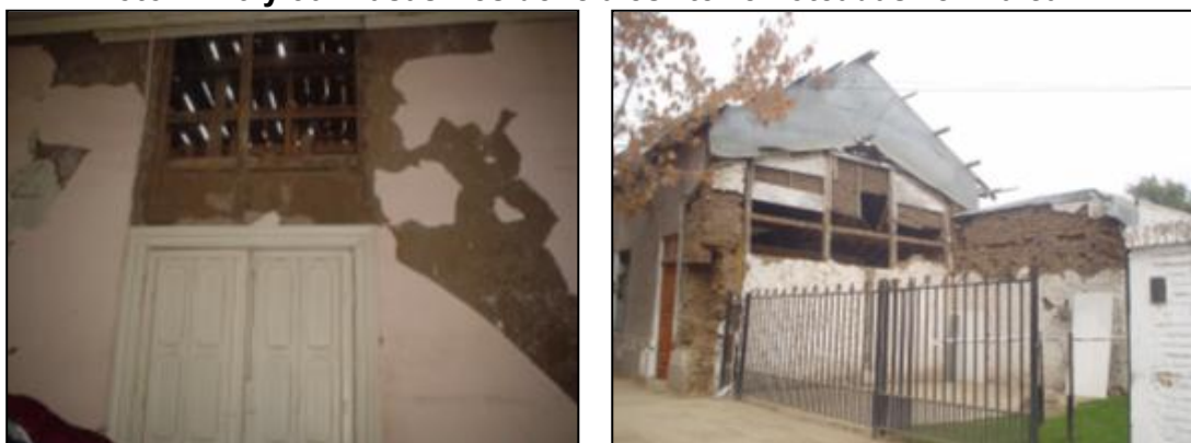
Foto N° 49 y 50: Casas Residenciales “terremoteadas” en Talca.
