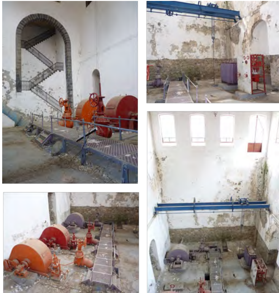
Imágenes 49, 50, 51 y 52. Interior de la antigua Sala de Turbinas de la ex fábrica de Metepec, donde se ven las turbinas, las escaleras, parte del tubo y elementos eléctricos. M. Castellanos
